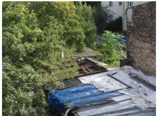
Abb. 19 Blick auf den hinteren Teil der Remise (schadhaftes Dach ohne Folienabdeckung)
