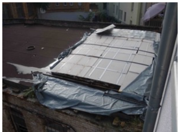
Abb. 15 leichtes Dach (Oberlicht) über Anbau, mit provisorischer Folien-Abdeckung
