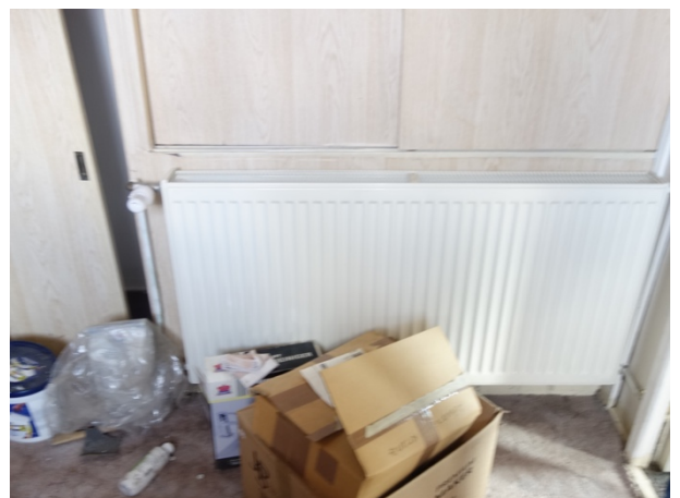
Abb. 49 Heizkörper im ausgebauten Raum DG
