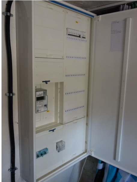
Abb. 56 Sicherungskasten im KG
