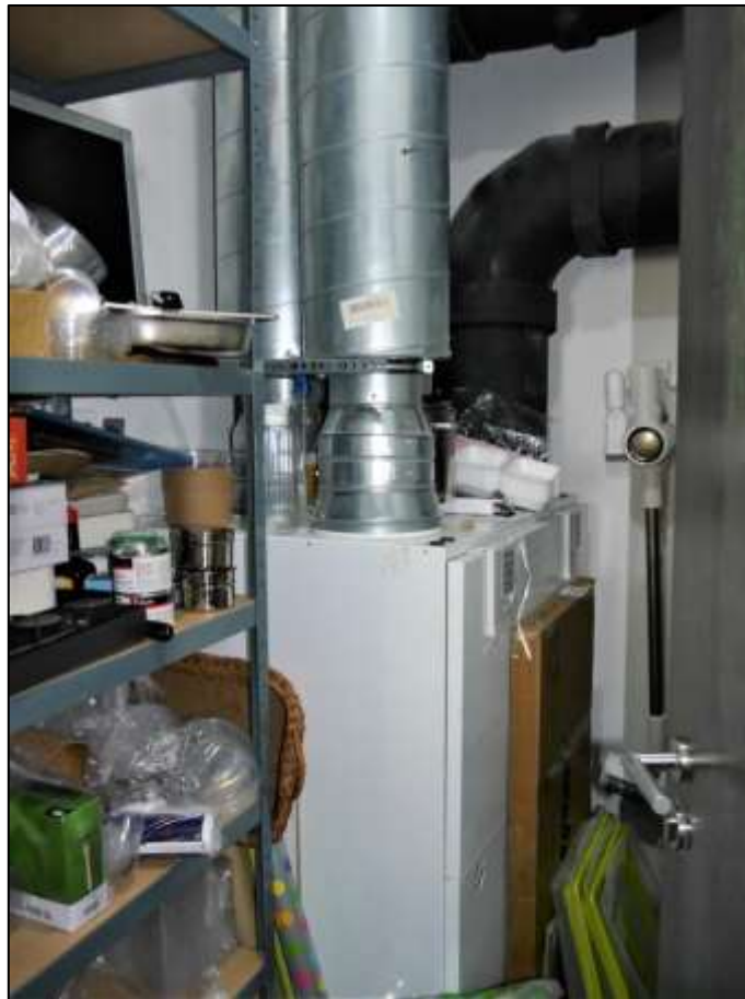
an den als Café etc. genutzten Großraumbereich anbindender innenliegender Technikraum mit Lüftungsaggregaten für die Raumluftechnische Anlage
