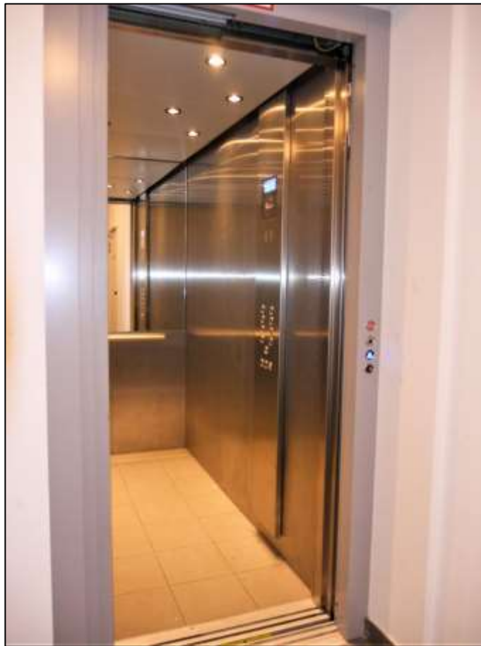
Aufzugsanlage mit Station im Keller- bzw. Un- tergeschoss im Bereich des Treppenhauses im Gebäudeteil Lindenstr. 28A
