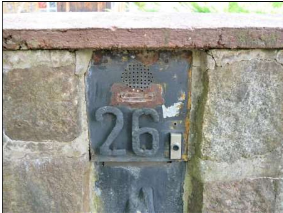
Klingel- und Gegensprechanlage rechts neben der Zugangspforte der Hauszuwegung in der straßenseitigen Grundstückseinfriedung des Grundstücks Heimfriedstraße 26
