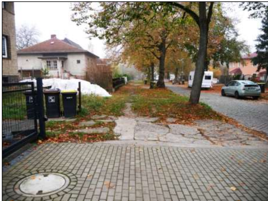
Grundstücksmaske als Grünstreifen zwischen dem Grundstück Urbacher Str. 28 u.a. mit sogen. Trampelpfad anstelle eines befestigten Gehwegs sowie brüchige Gehweg- bzw. Grünstreifenüberfahrt von dem befestigten Fahrdamm auf das Grundstück Urbacher Str. 28
