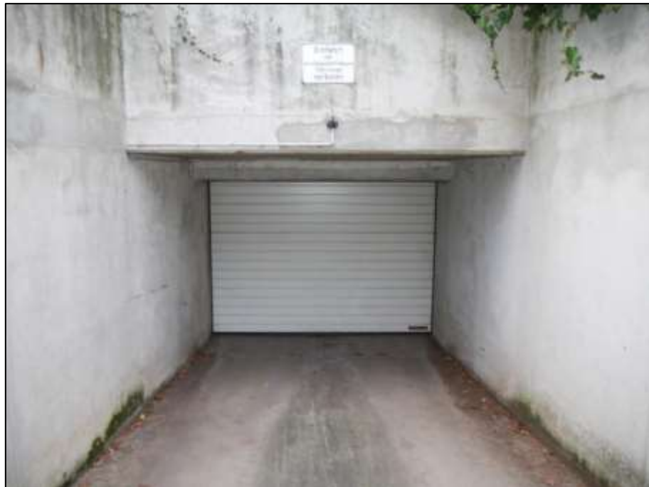
Tiefgaragenrampe mit elektrisch zu bedienendem Sektionaltor der Ein- und Ausfahrt
