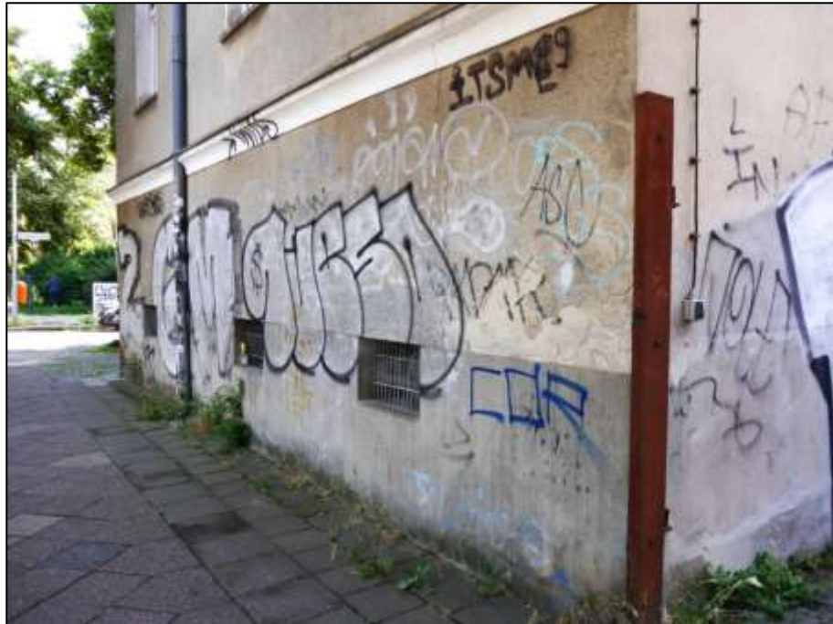
Sockelzone im Bereich des Souterrains an der zur Friesickestraße orientierten Front des Wohnhauses auf dem Eckgrundstück
