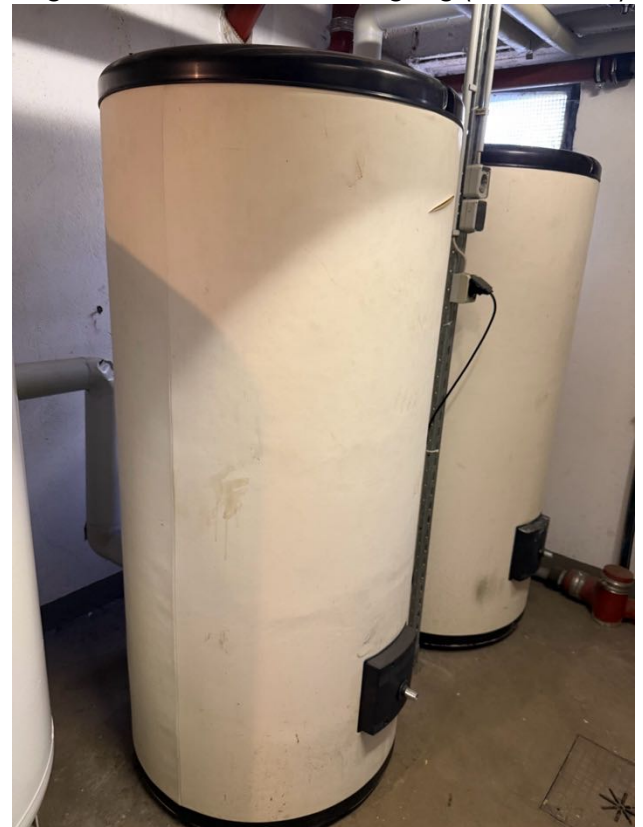
Heizungs- und Warmwasserversorgung (Fernwärme)
