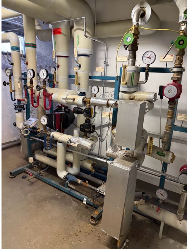
Technik im Versorgungsbereich
