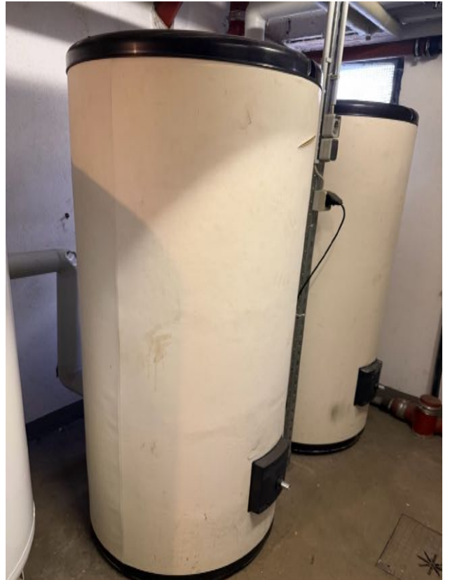
Heizungs- und Warmwasserversorgung (Fernwärme)
