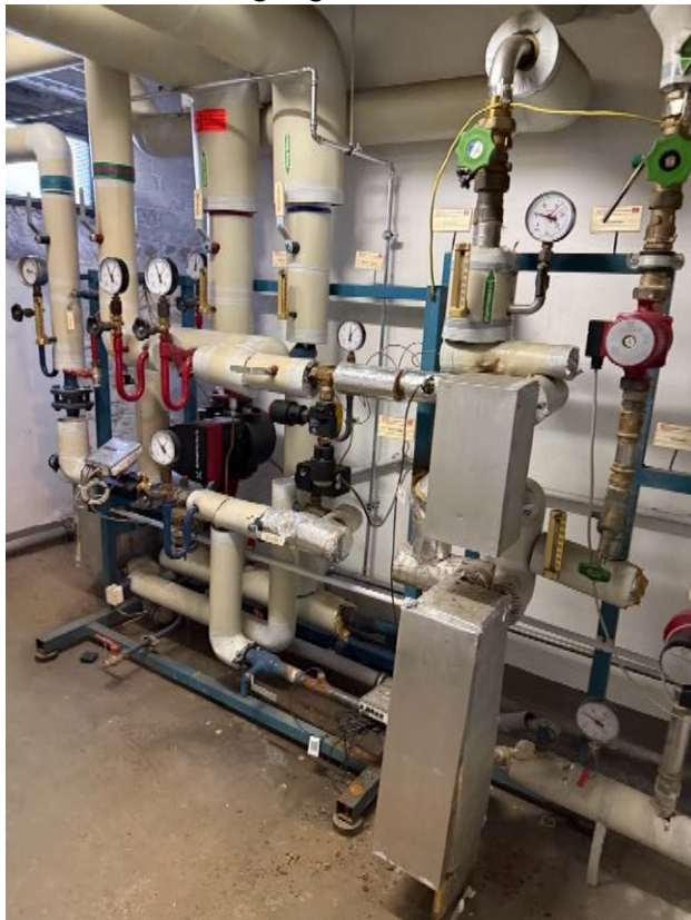
Technik im Versorgungsbereich
