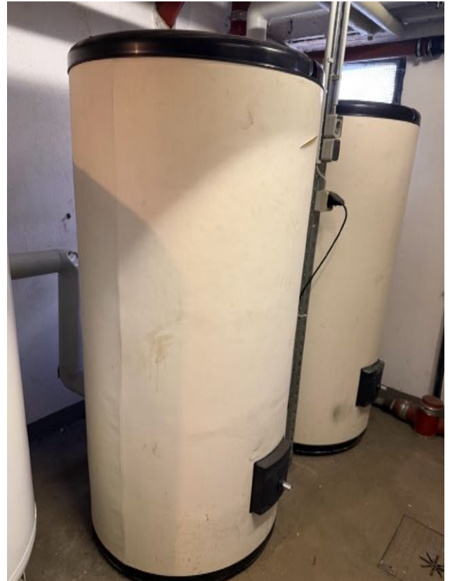
Heizungs- und Warmwasserversorgung (Fernwärme)
