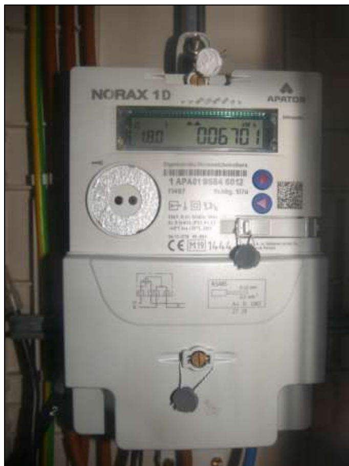
typischer elektronischer Stromzähler im Quergebäude-treppenhaus
