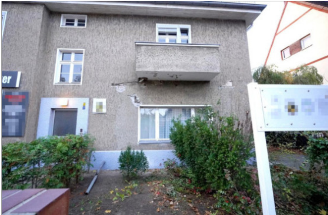
Straßenansicht Gebäudeteil Hausnummer 31 mit Fassadenschäden
