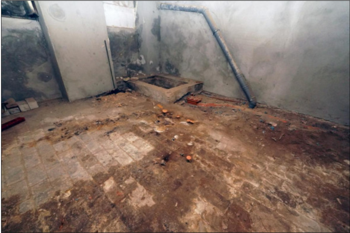
Kellerraum mit Feuchtigkeit
