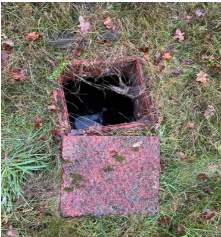
Eiskellerweg 12, Berlin - Fäkaliengrube
