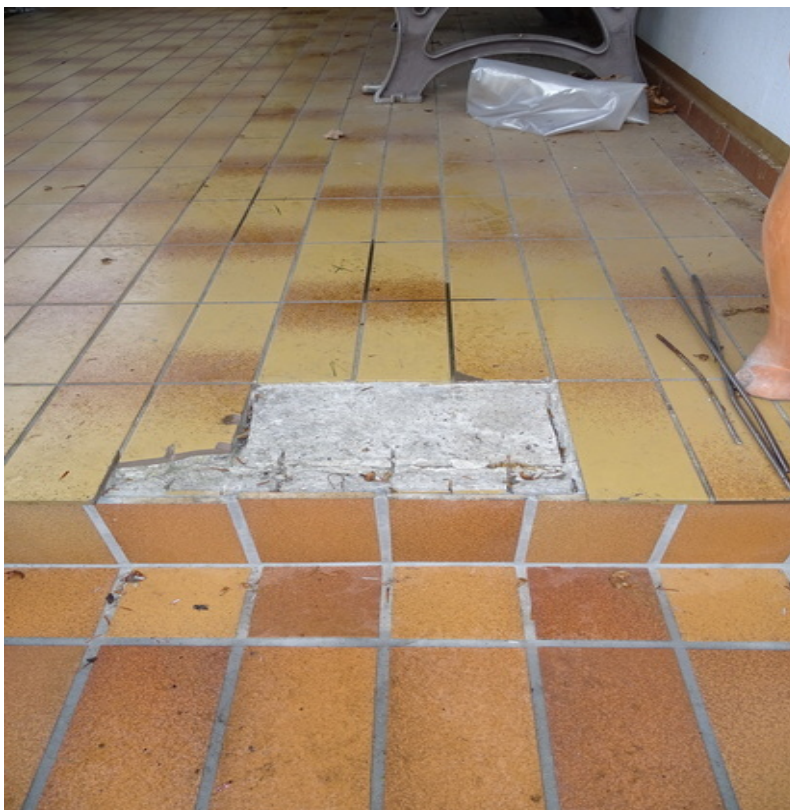
Eiskellerweg 12, Berlin – Defekte Fliesen im Treppenbereich
