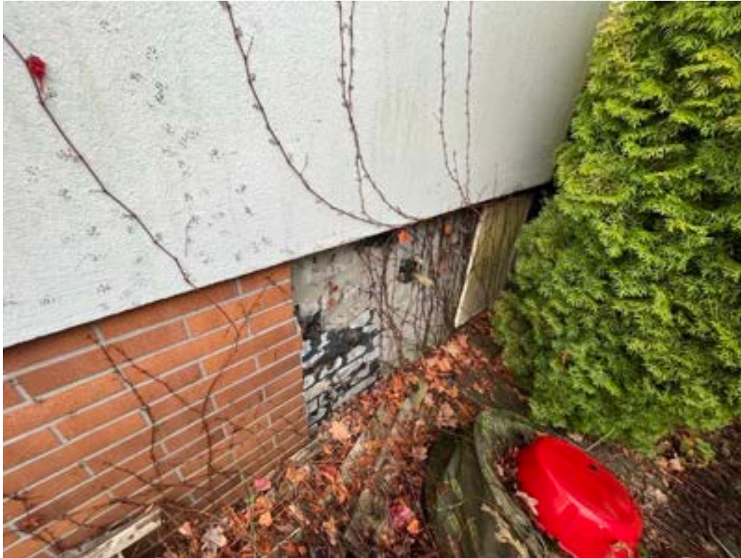
Eiskellerweg 12, Berlin – Außenwandschaden an der Terrasse
