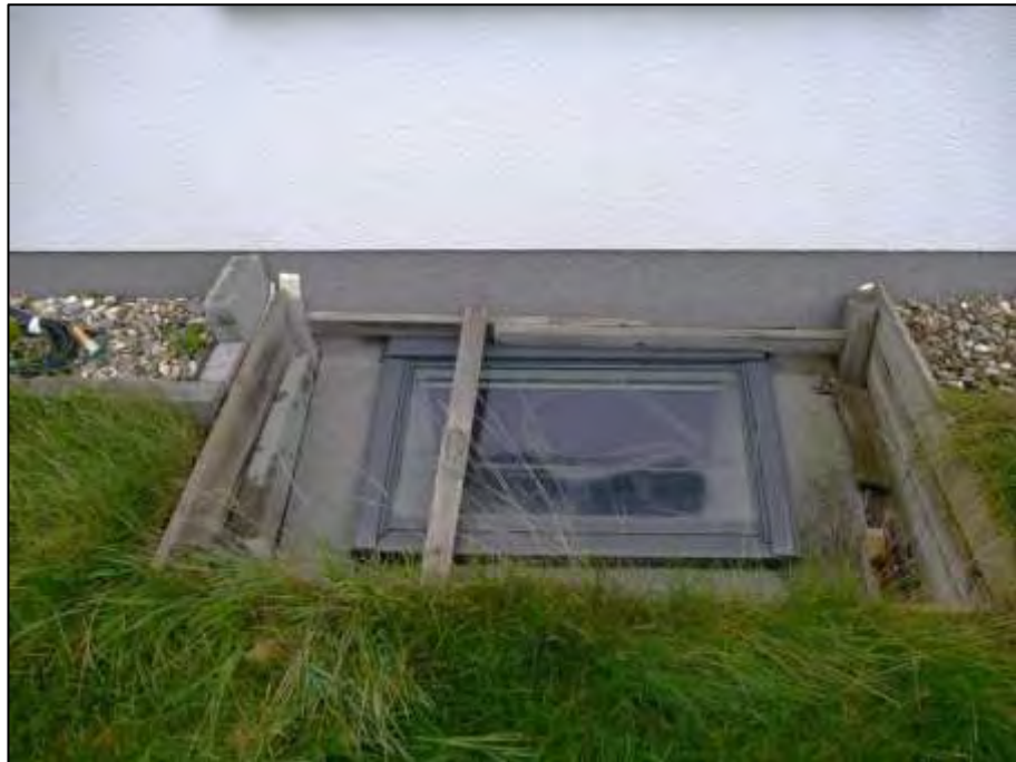
Lichtfluter als spezieller Kellerlichtschacht vor der freien Giebelseite
