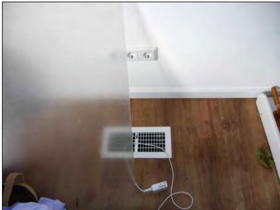
Ausblasöffnung der Be- und Entlüftungsanlage im Laminatboden
