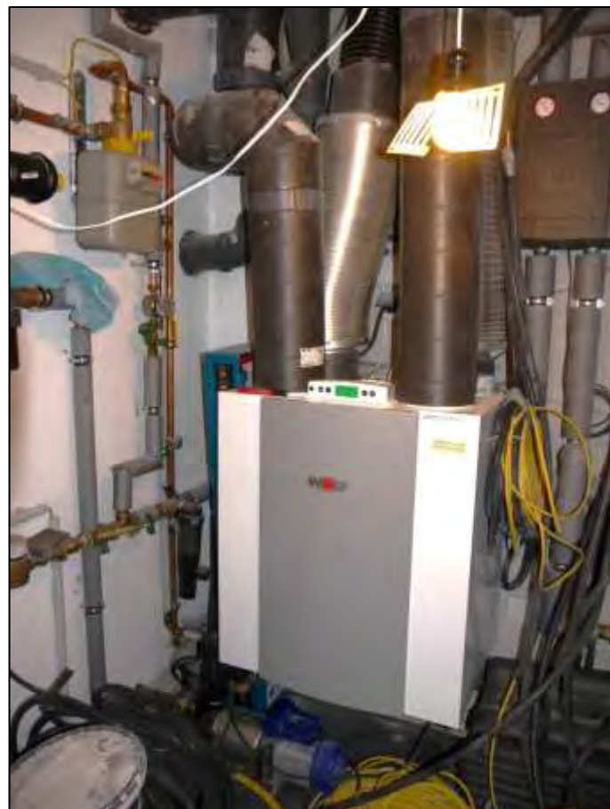
Gas-Anschluss und Heiztherme im gefangenen Raumbereich des verbundenen Hauswirtschafts- und Hausanschlussraums
