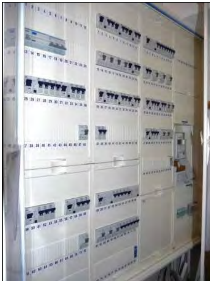
Elektro-Verteilung mit Stromzähler im verbundenen Hauswirtschafts- und Hausanschlussraum
