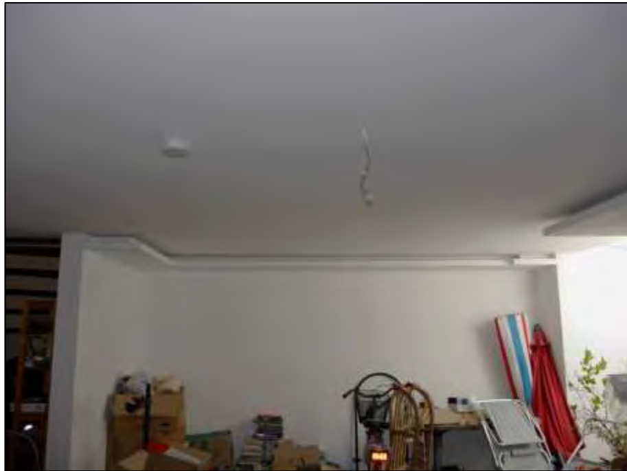
Deckenabspannungen als Konsolen für Lichtinstallationen im Hobbyraum im Kellergeschoss mit links im Bild offen anbindender Kellerdiele nebst Treppenaufgang
