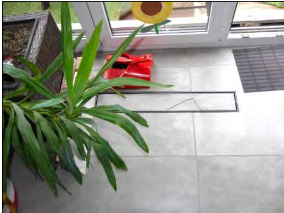
Ausblasöffnung der Lüftungsanlage in der Plattierung des Bodens
