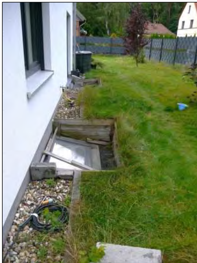
Lichtfluter als spezieller Kellerlichtschacht vor der freien Giebelseite
