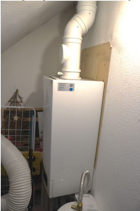
Heizungsanlage mit Warmwassererhitzung
