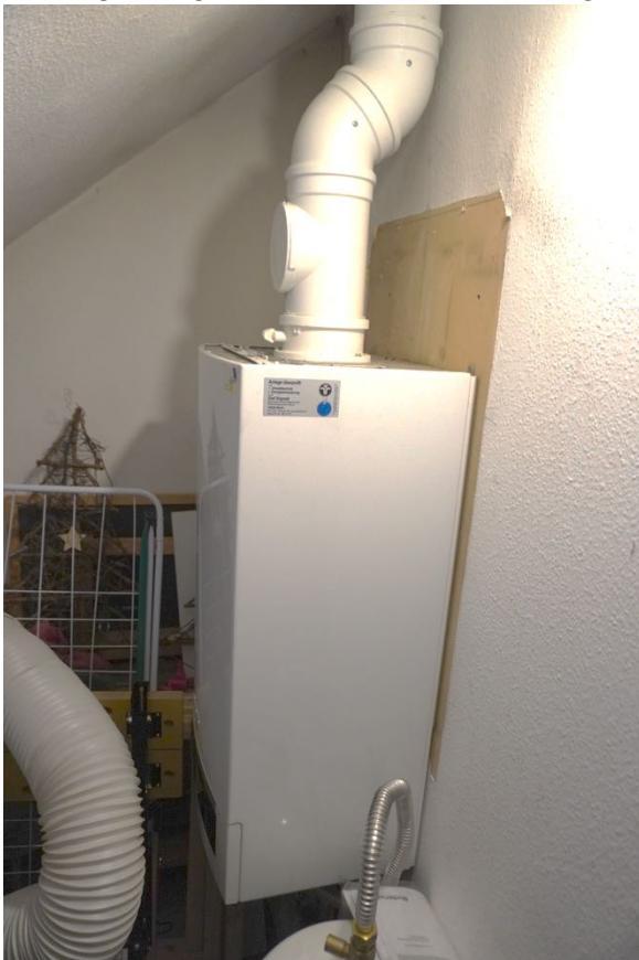
Heizungsanlage mit Warmwassererhitzung
