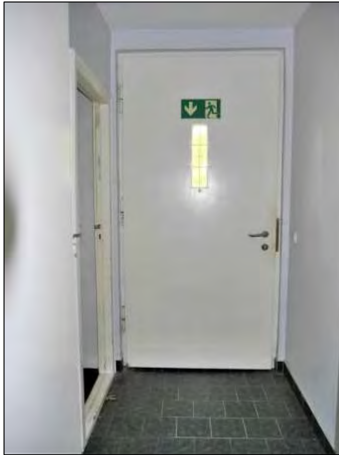
Blick aus der Diele (Empfang) auf den Hauseingangswindfang mit straßenseitiger Hauseingangstür und links anbindendem Kellertreppenabgang
