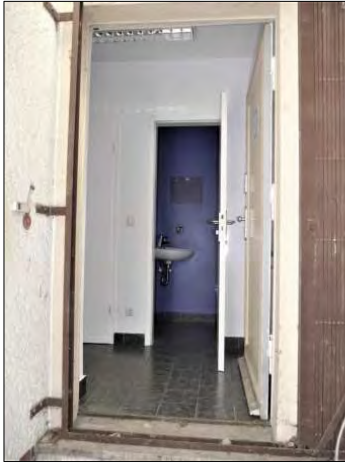
Hauseingangstür in der rückwärtigen Stirnseite des zum linken Bauwich orientierten 1-geschossigen Vorbaus des Gebäudestamms mit anbindendem Flur quasi als Windfang anliegenden 2 Toilettenräumen
