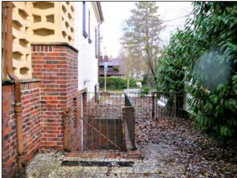
zum linken Bauwich nach Osten orientierte Gebäudefront im Bereich des 1-geschossigen gleichfalls unterkellerten Vorbaus mit davor belegener Kelleraußentreppe und davor links im Bild anbindendem weiterem Gebäudeeingang zum Hochparterre
