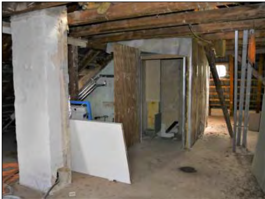
Rohdachboden mit allenfalls erst partiell eingehaustem Zugang über die Deckenöffnung als Bodenluke für die Anstalleiter mit provisorischer OSB-Plattentür
