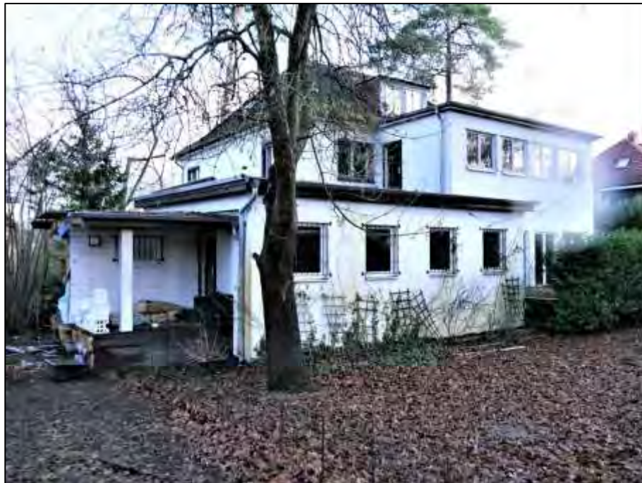
Blick nach Nord-Osten auf die gartenseitige nach Süden und die zum rechten Bauwich nach Westen orientierten Gebäudefronten mit Garagen-Aufstockung und teilabgebrochenem hölzernem Verbindungsbau im Vordergrund und dahinter anbindendem 2-geschossigem Anbau
