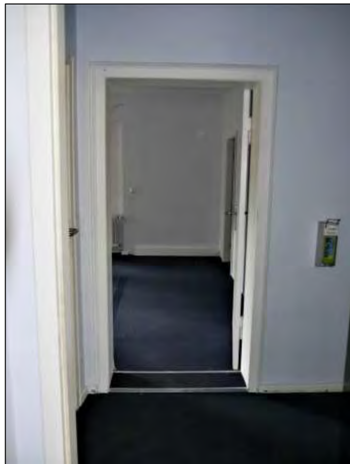
Blick durch die Zugangstür des an die Galerie anbindenden Flurs mit dahinter zum linken Bauwich orientierten Büro- raum und links im Flur anbin- dender innen- liegender Kam- mer mit Anstell- leiter zur Dach- bodenluke
