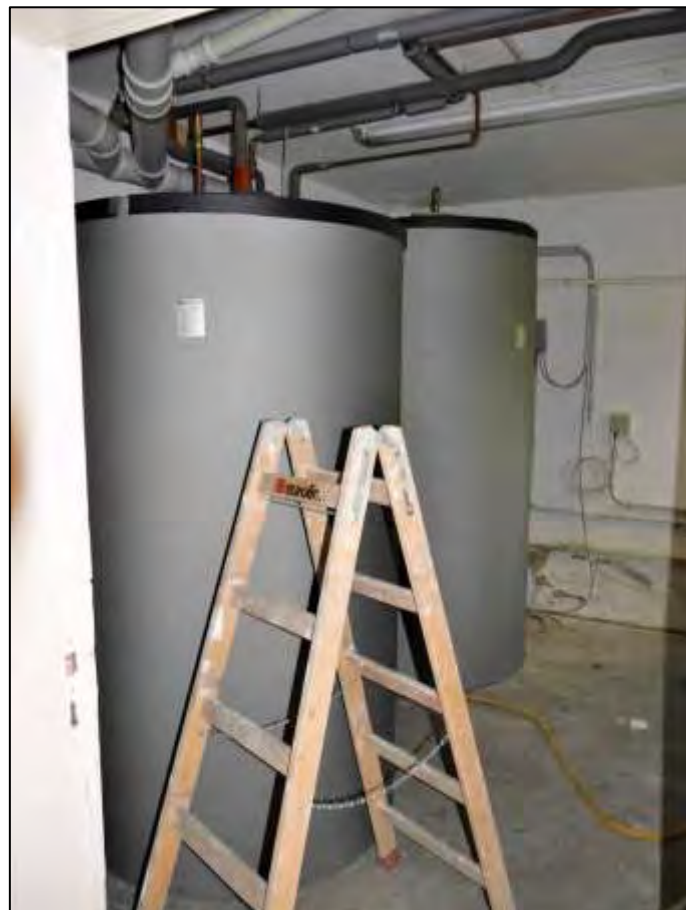
Lagerraum mit Warmwasserspeichern und über Terrain liegendem Fenster mit Orientierung zum linken Bauwich
