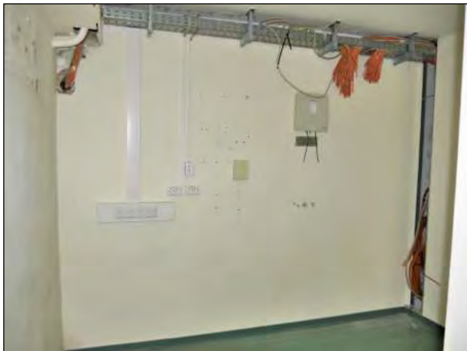
an den zum rechten Bauwich orientierten Kellerraum mit Zugangstür aus dem Bereich der Garagenrampe straßenseitig anbindender Serverraum
