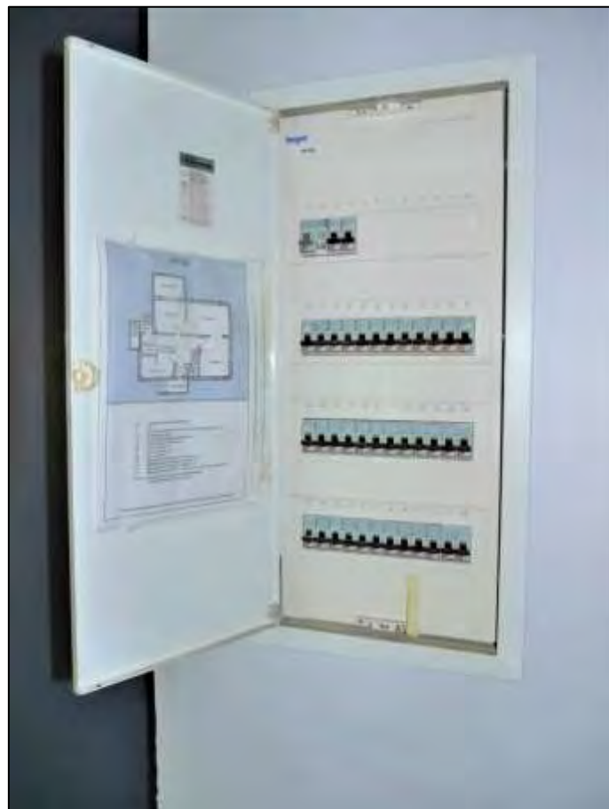
Sicherungstabelleau für das Hochparterre In dem straßenseitigen Büroraum nebst der Tür zur Diele
