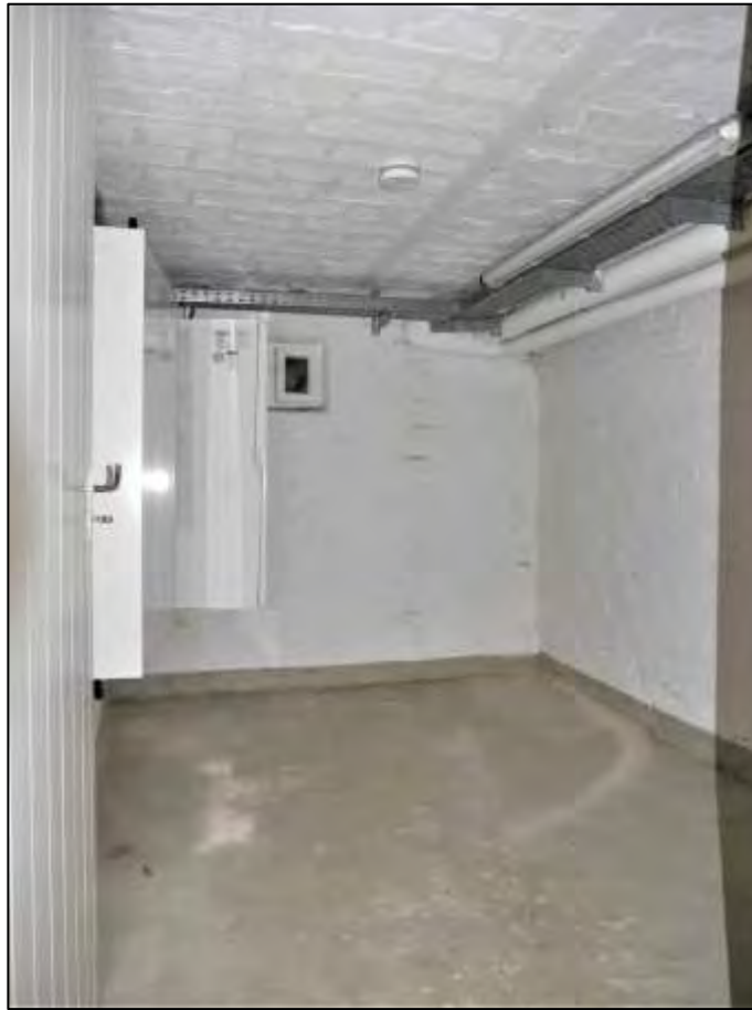
höher liegender innenliegender Lagerraum mit Elektroverteilung
