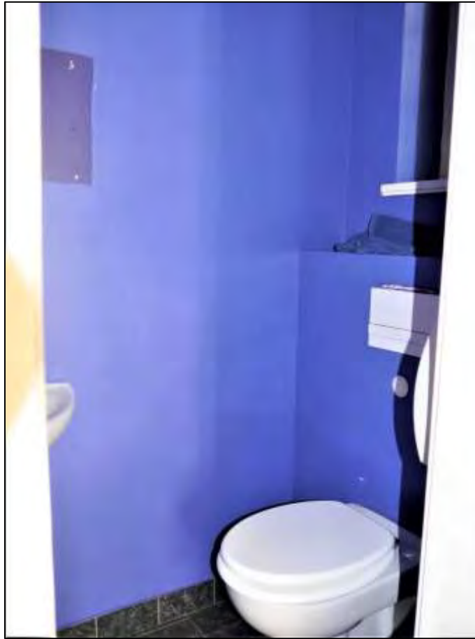
Toilettenraum im Flur hinter der Hauseingangstür in der rückwärtigen Stirnseite des zum linken Bauwich orientierten 1-geschossigen Vorbaus
