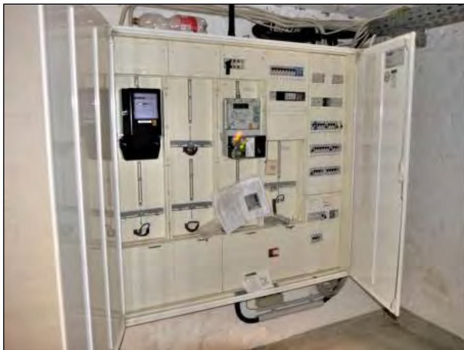
Elektroverteilung im höher liegenden innenliegenden Lagerraum
