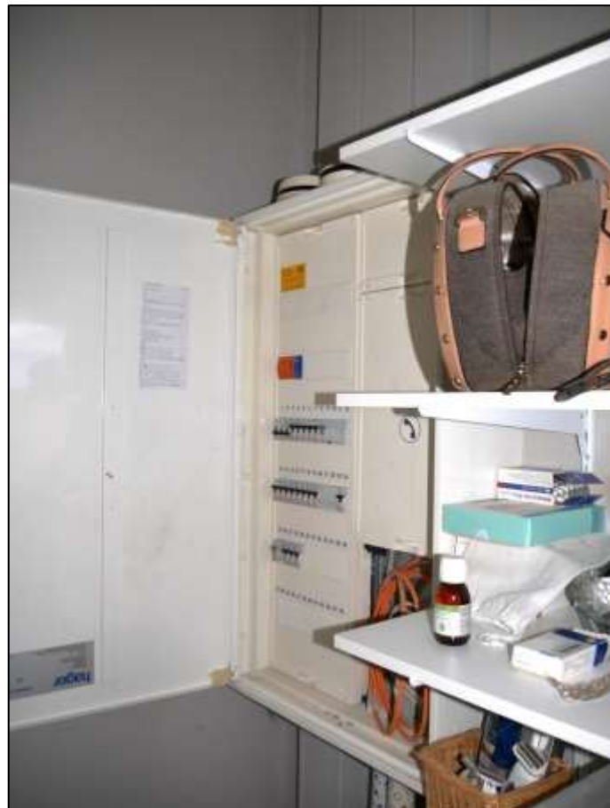
Elektro-Verteilerkasten mit Sicherungsautomaten im Ankleidezimmer in der in der früheren Gymnastikhalle belegenen Nutzungseinheit
