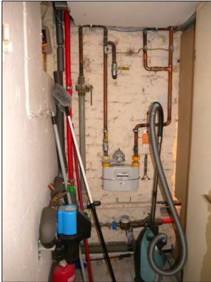
Frischwasser- und Gasanschluss mit unterdimensioniertem Gaszähler im Kellergeschoss der Altbau-Villa aufgrund der Gasversorgung sowohl für die Altbau-Villa als auch für die auf dem Grundstück belegene frühere Gymnastikhalle
