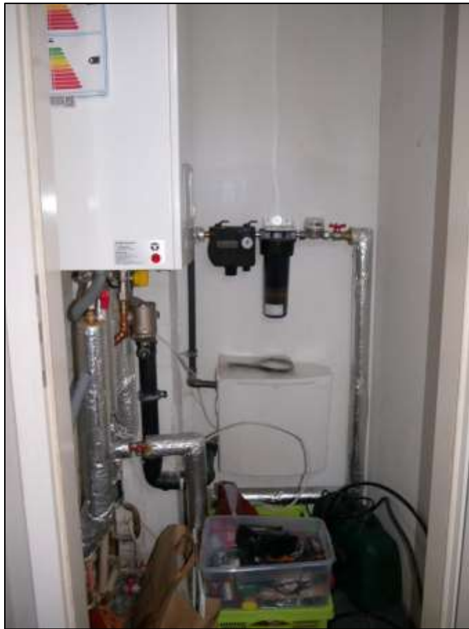
Kammer mit Zugang aus dem an das Duschbadezimmer angrenzenden Ankleidezimmer mit Gas-Kombitherme und Schmutzwasser-Kleinhebeanlage in der Nutzungseinheit in der früheren Gymnastikhalle
