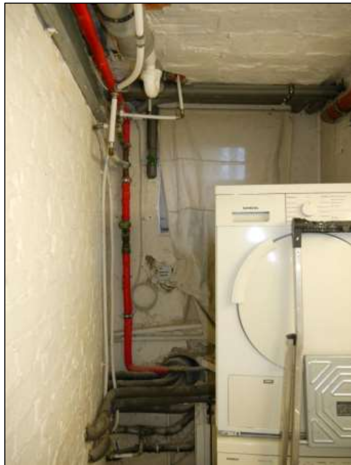
Toilettenraum im Kellergeschoss der Altbau-Villa mit verbliebenen defekten Wasch- und Trockenautomaten und Rohrhülse in der westlichen Außenwand zur Durchleitung von Heizleitungen der früheren Wärmeversorgung über ein auf dem westlichen Nachbargrundstück vormals betriebenes Blockheizwerk
