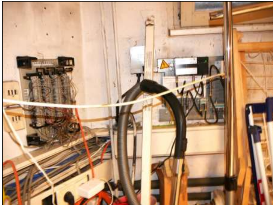
Elektroinstallationen u.a. als Kabelkanal und Schwachstromanlage sowie frei hängende Mantelkabel im Hauswirtschafts- und Hausanschlussraum mit Nutzung auch als Heizzentrale im Kellergeschoss der Altbau-Villa
