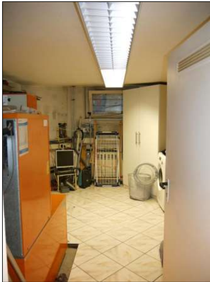
Hauswirtschafs- und Hausanschlussraum mit Nutzung auch als Heizzentrale im Kellergeschoss der Altbau-Villa
