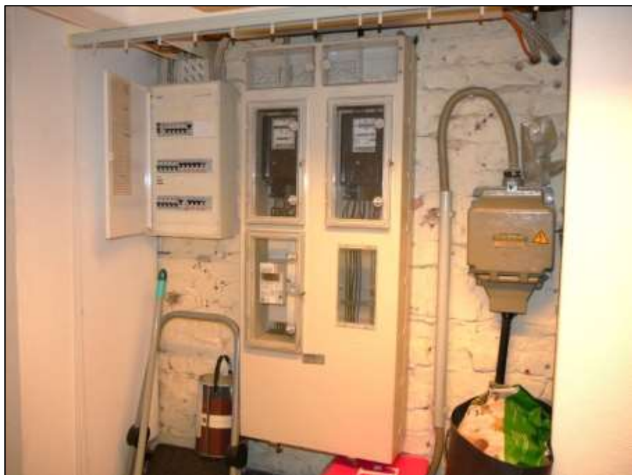
Raumnische im Hauswirtschafts- und Hausanschlussraum bzw. der Heizzentrale mit Sicherungstableau und Stromzählerplätzen u.a. auch für die ehemalige Gymnastikhalle und eine ehemals im Kellergeschoss der Altbau-Villa betriebene Gewerbeeinheit
