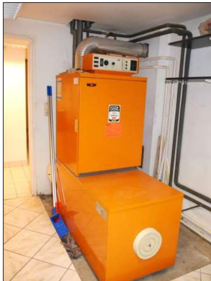
Gasheizkessel nebst Warmwasserspeicher Aus dem Jahre 1994/1995 im Kellergeschoss der Altbau-Villa
