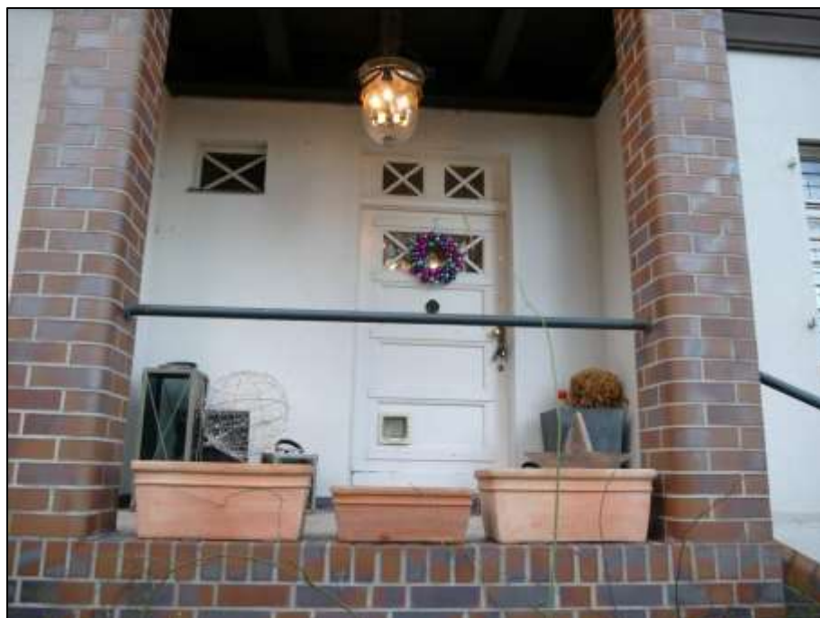
Hauseingangstür unterhalb der im Obergeschoss u.a. auf zwei Mauerwerkpfeiler aufgelagerten Balkonterrasse der Altbau-Villa
