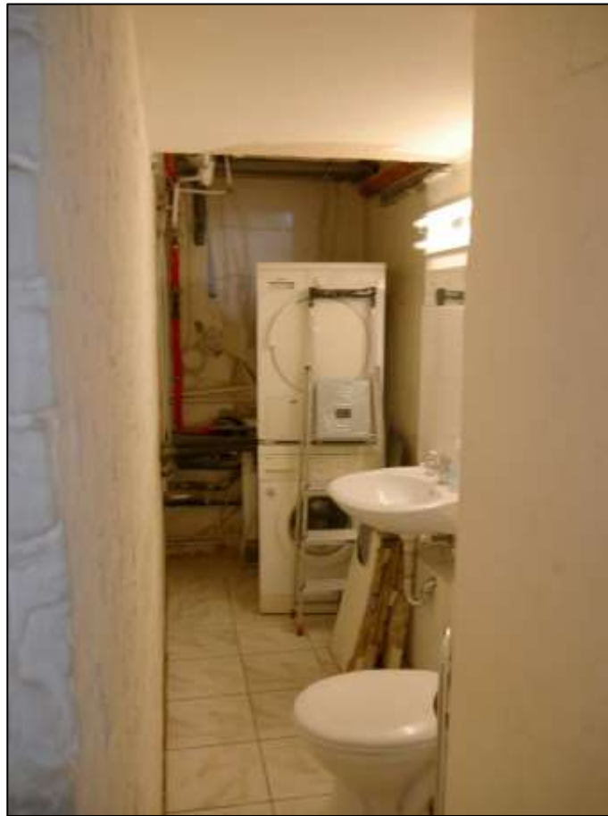
Toilettenraum im Kellergeschoss der Altbau-Villa mit verbliebenen defekten Wasch- und Trockenautomaten, weil in die später eingebaute Wandscheidung zum Flur eine für einen Abtransport zu schmale Tür eingebaut worden ist
