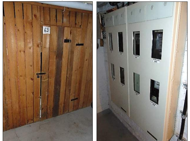
Foto 10/10a Links: Kellerraum Nr. 63. Rechts: Anordnung der Stromzähler im Kellergeschoss.
