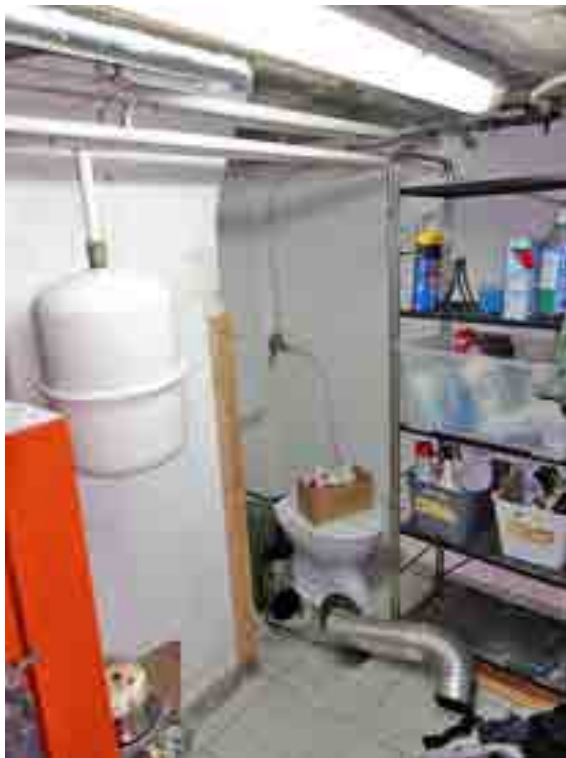
Heizungskeller und Waschküche
