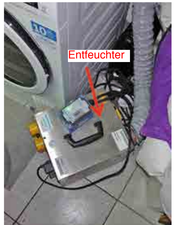
Heizungskeller und Waschküche
