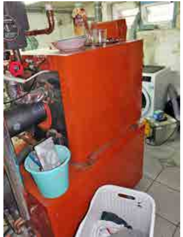
Heizungskeller und Waschküche
