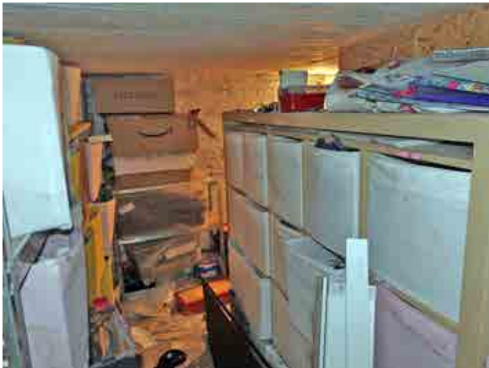
Kellerraum mit Öltank
