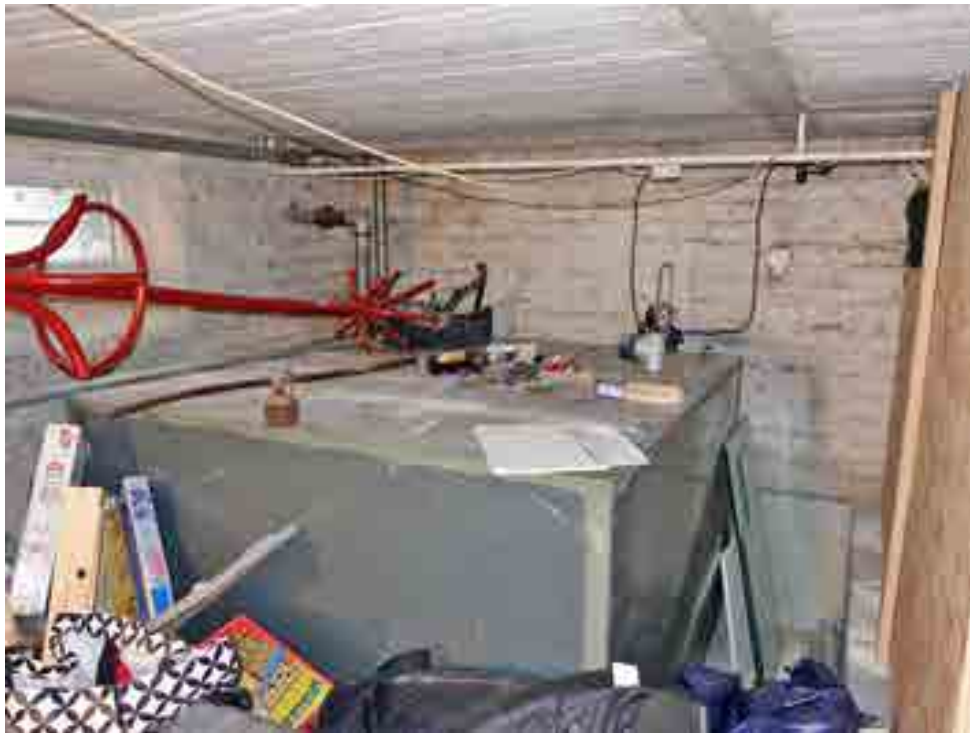
Keller, Kellerraum mit Öltank
