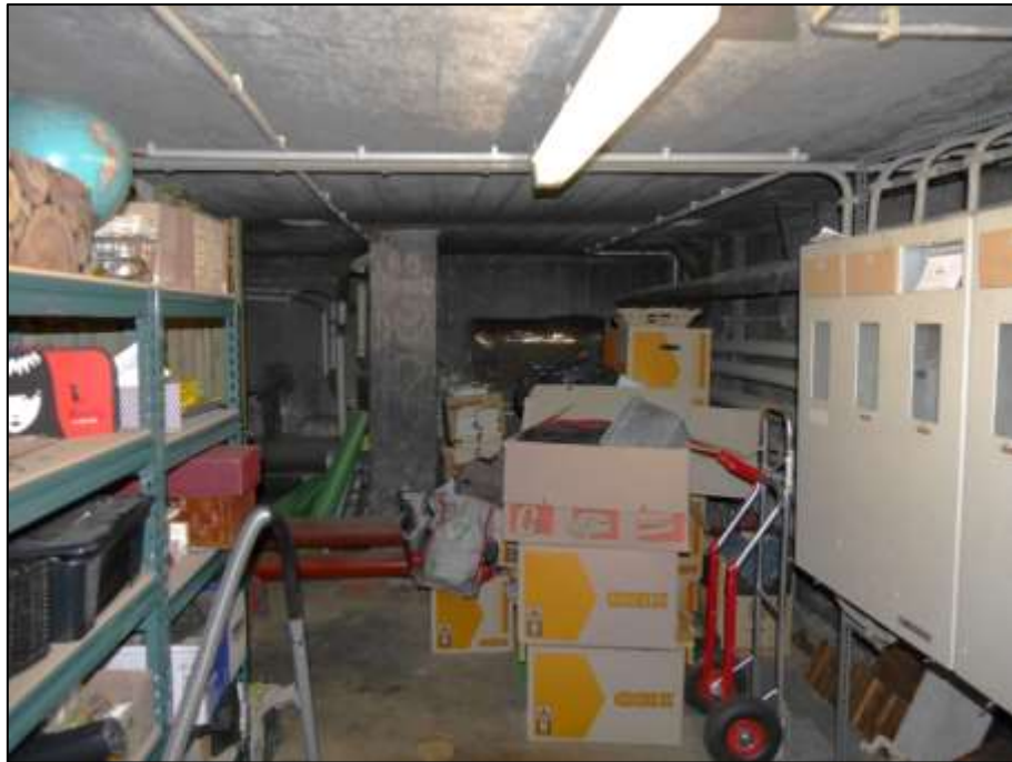
Hausmeisterraum und Hausanschlussraum (Elektro) im Kellergeschoss des Gebäudeteils Holländerstr. 15 mit schalungsrauen Schüttbetonwänden und entsprechender Raumdecke
