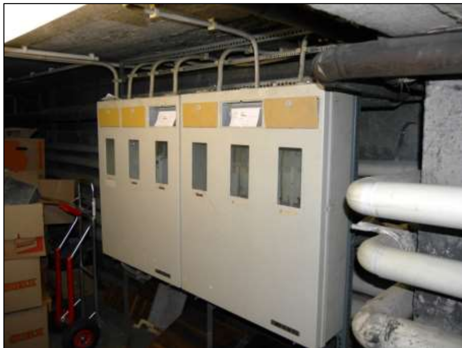
zentralisierte Stromzähleranlage (durchweg Wechselstromzähler) im Kellergeschoss des Gebäudeteils Holländerstraße 15
