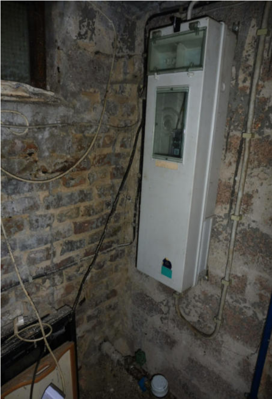
Hausanschlüsse im Keller
