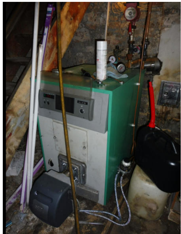
Ölheizung im Kellerraum
