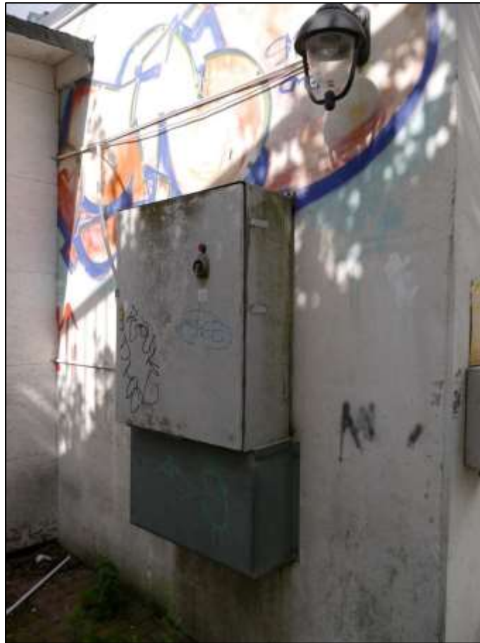
rückwärtige Garagenfront mit elektrischer Verteilung und Sicherungen etc.
