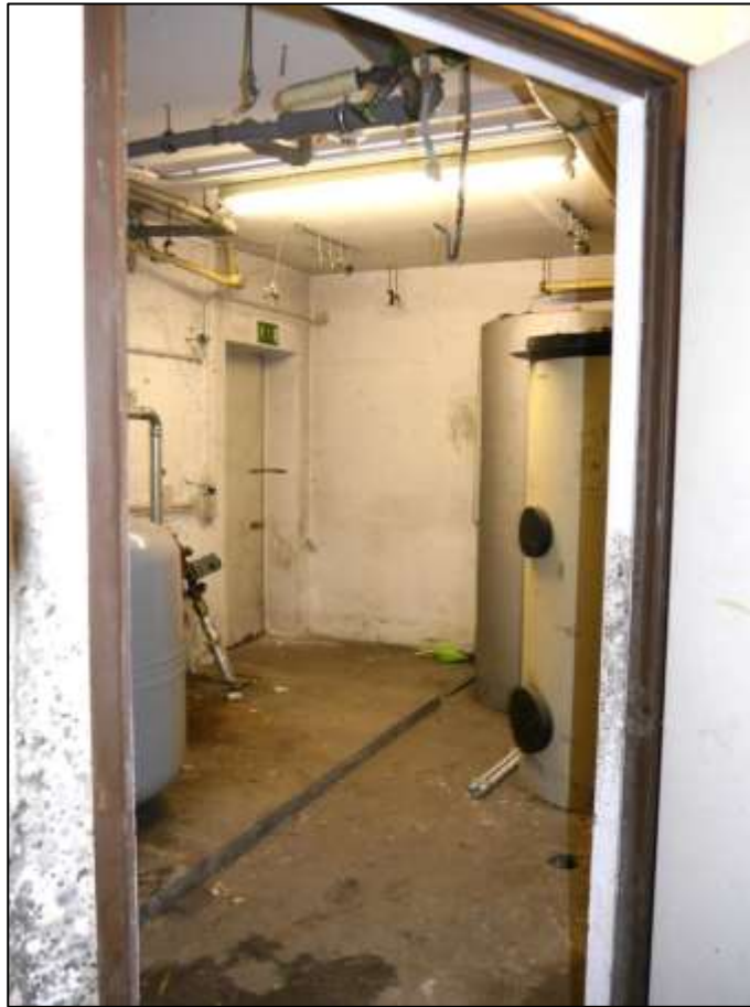
Warmwasserspeicher der Gas-Zentralheizung nebst separater Außentür zur Kelleraußentreppe
