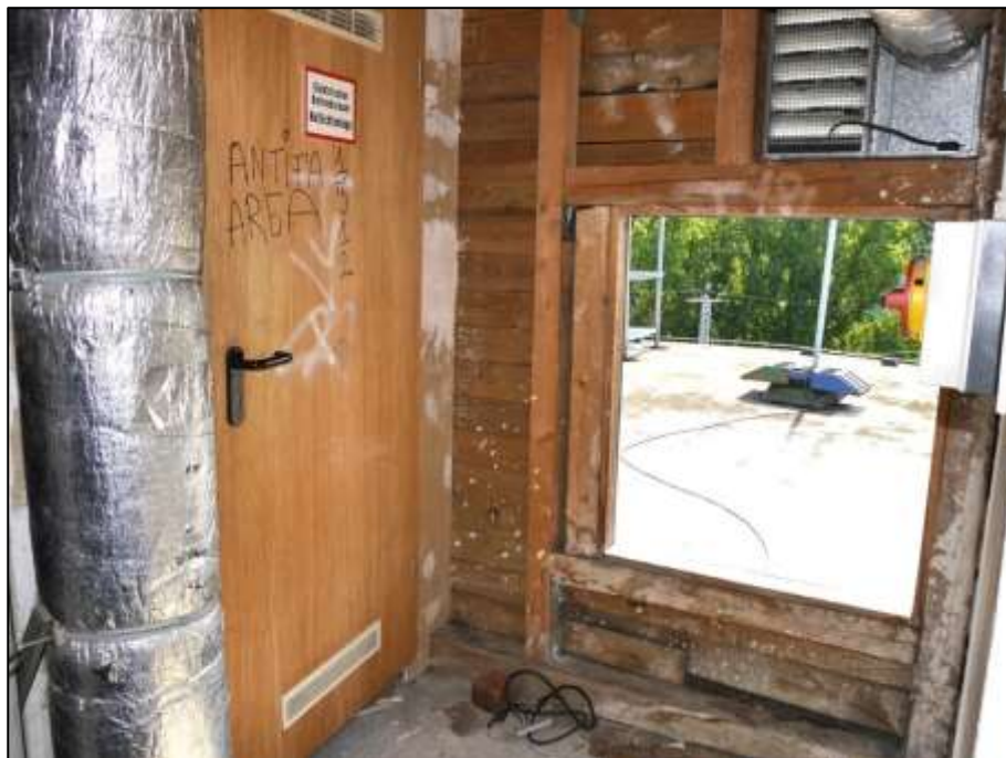
Zugang zur Notlichtzentrale links und Luken-Ausgang zur hofseitigen Plateaufläche über dem Dachgeschoss
