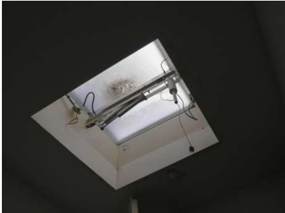
Lichtkuppel als RWA-Anlage im Treppenhauskopf
