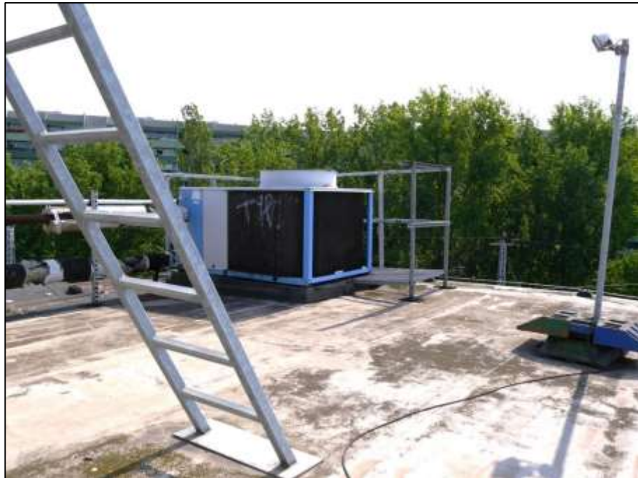
auf der hofseitigen Plateaufläche über dem Dachgeschoss installierter Adiabater Rückkühler der RLT-Anlage und im Vordergrund: Leiter auf das Dach des Bodenraums
