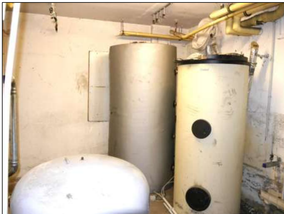
Warmwasserspeicher der Gas-Zentralheizung im Kellergeschoss
