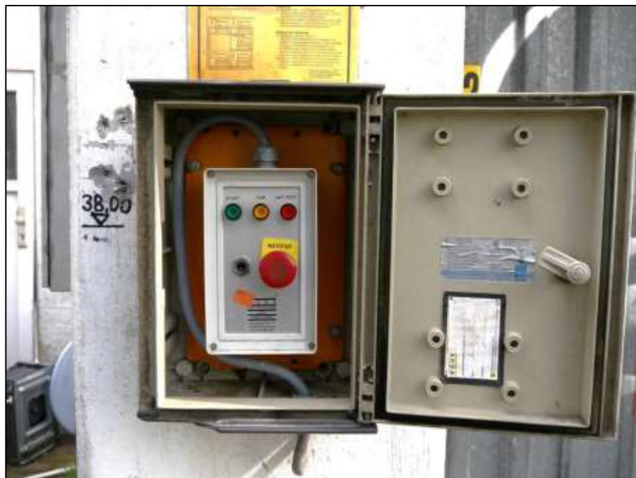
vordere Garagenfront mit Steuerung des Parkliftersystems nebst Schiebebühne für 8 PKW
