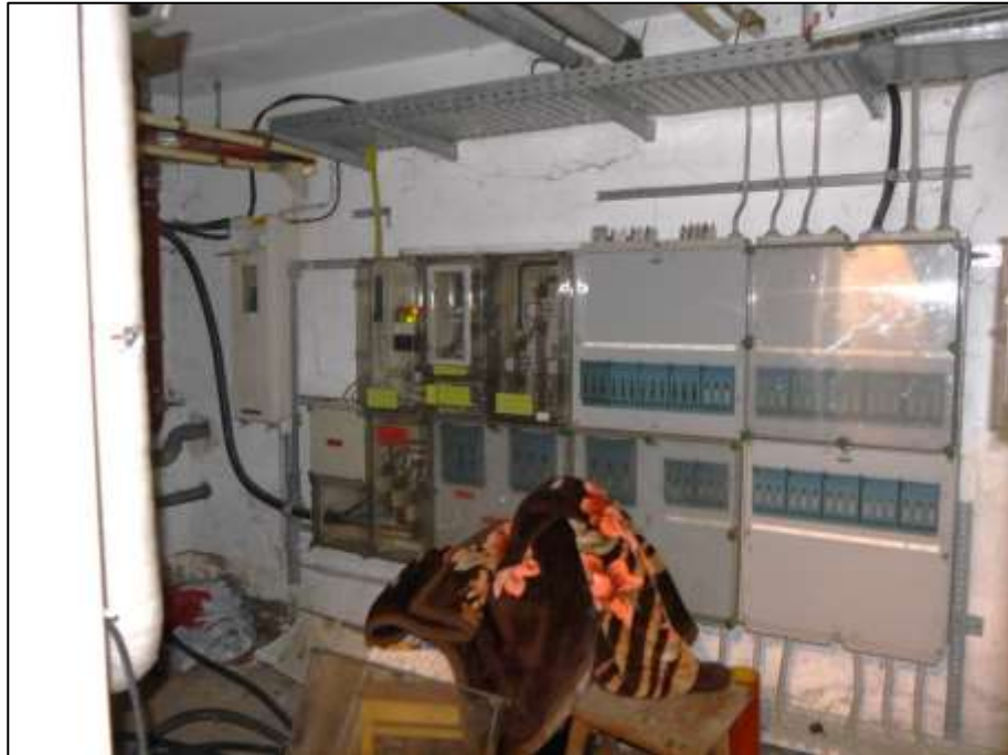
Hausanschlussraum mit Elektroverteilung
