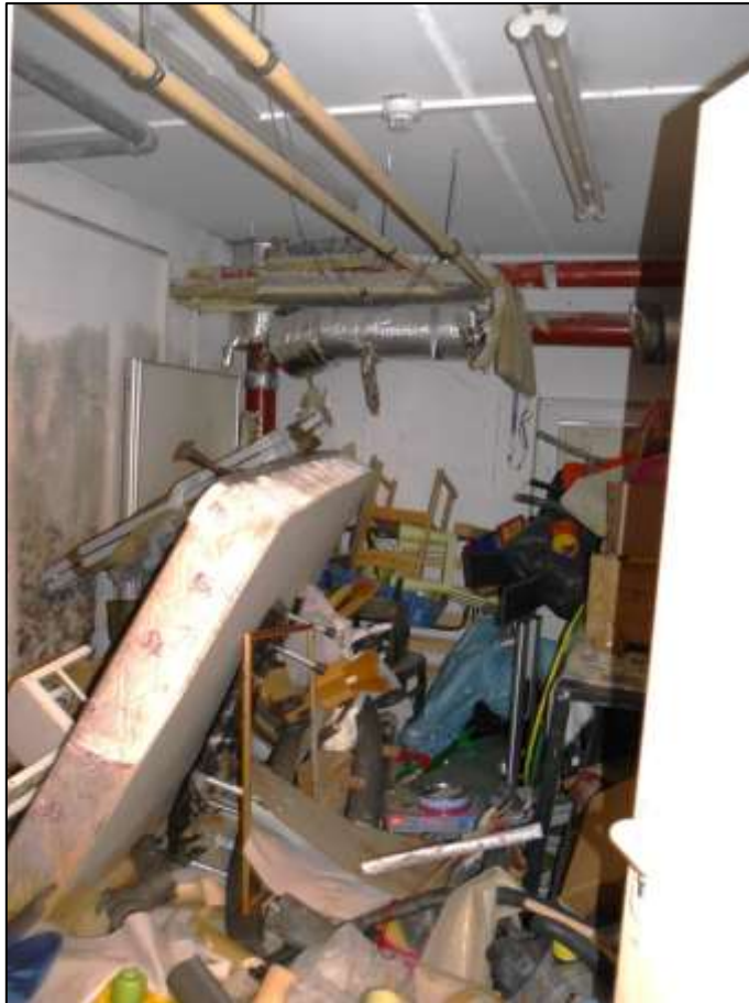
Lagerraum mit durchnässten Wandumfassungen links im Bild
