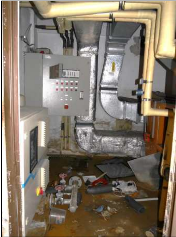
Lüftungsanlage mit Steuerung im Kellerge- schoss
