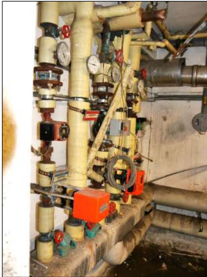
Heizleitungsstränge der Gas-Zentralheizung
