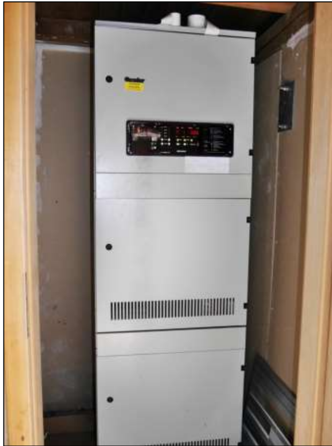
Steuerung der Notlichtanlage im Dachboden
