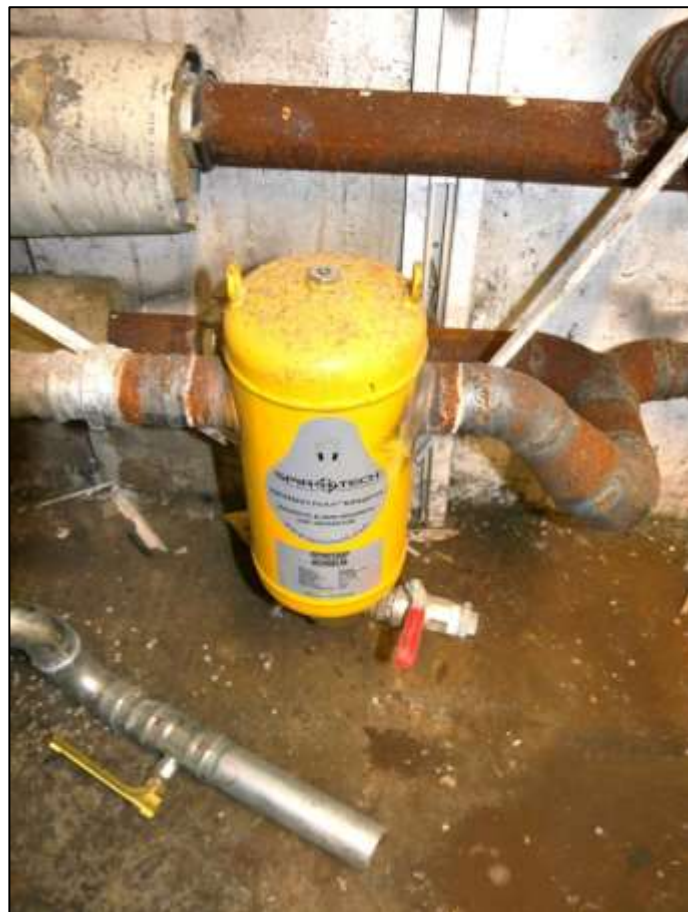
Schlammabscheider im Kellergeschoss
