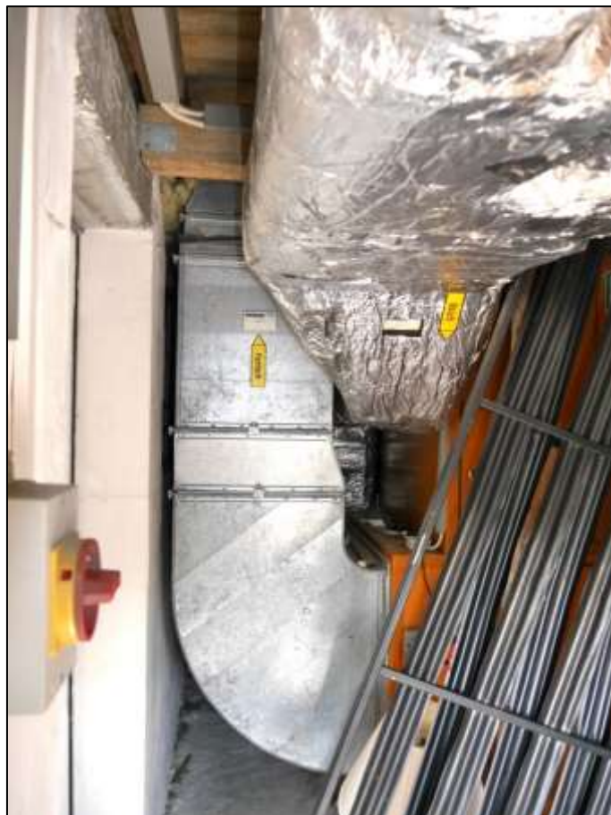
Lüftungsanlage im Dachboden
