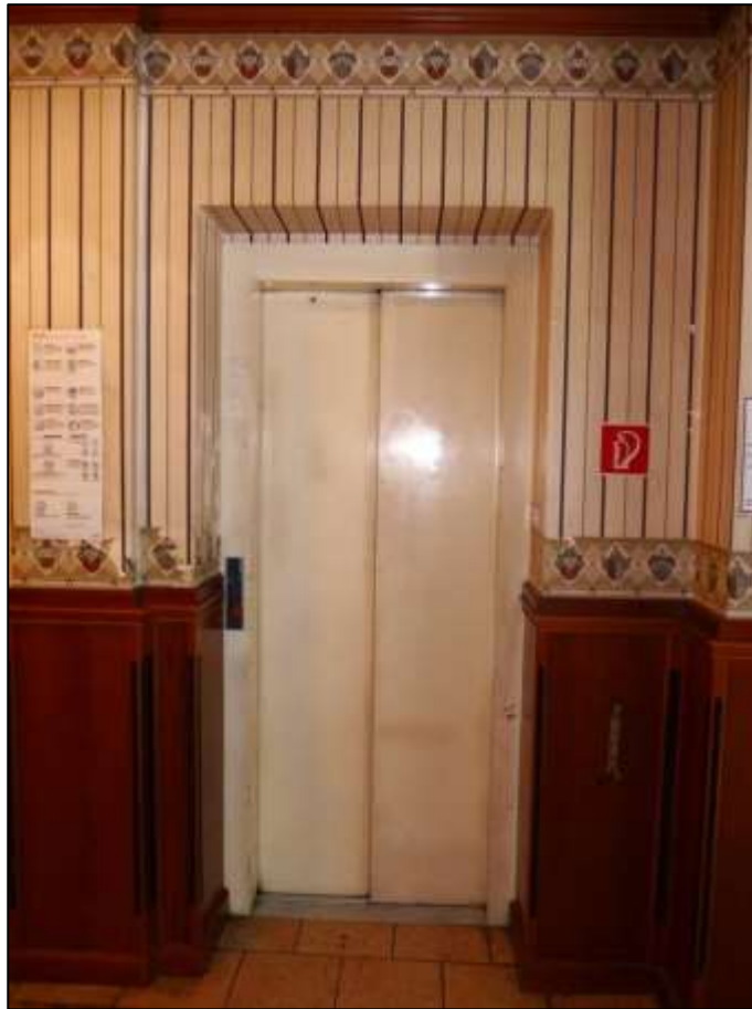
Aufzug mit Station im Erdgeschoss in der Lounge
