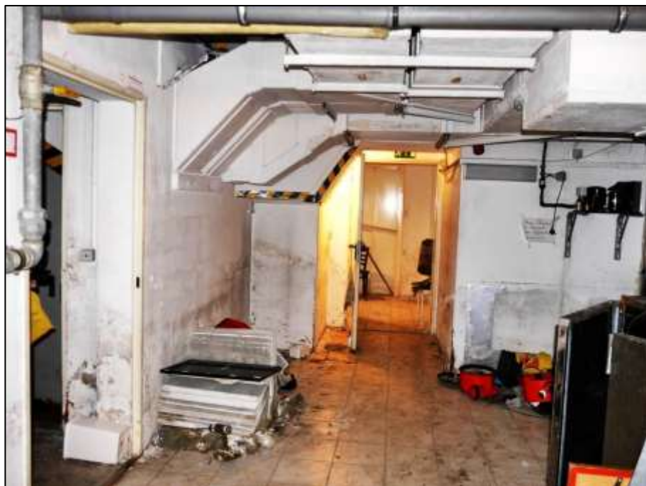
zentrale Kellerdiele mit Blick in Richtung des Flurs sowie Lüftungskä- nälen unter der Raumdecke
