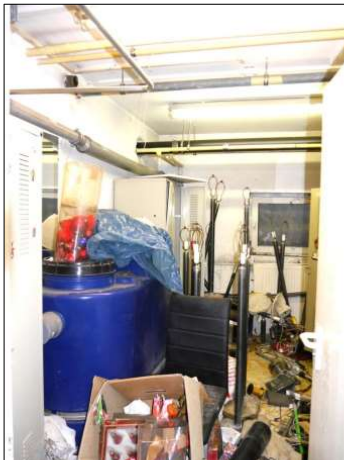
Personal- Umkleide mit Buderus-Gas- Heizkessel
