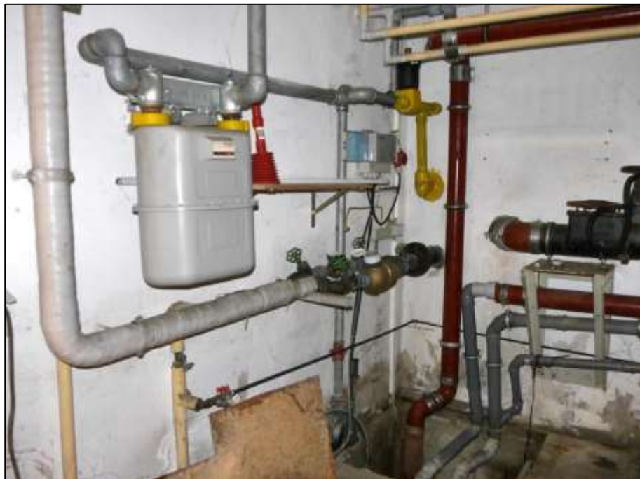
Hausanschlussraum mit Wasser- und Gas-Anschluss, Hebeanlage und Schmutzwasser-Grundleitung
