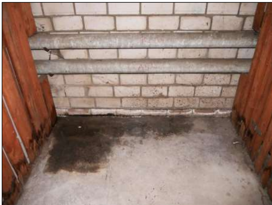
Durchnssungsbereich aufgrund von Tropfwasser aus den darber liegenden Geschossen bzw. urschlich aus dem Aufstockungsbereich
