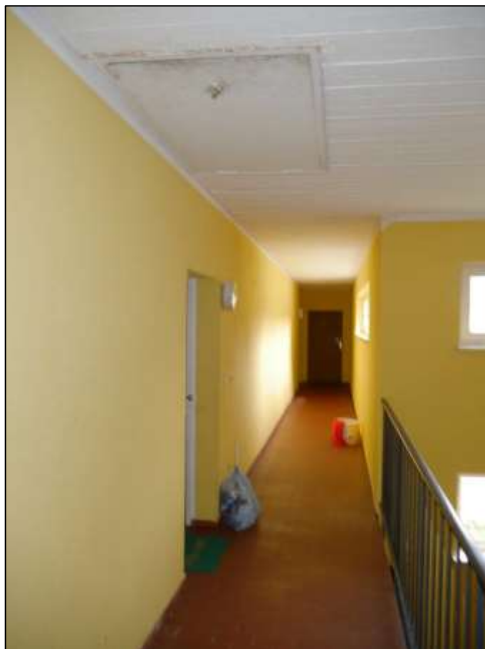
Treppenhausflur im 1. Obergeschoss mit Ausstiegsluke einer Einschubtreppe zum ehemaligen Flachdach des ursprünglichen Gebäudebestandes (bereits aufgrund der Aufstockungsmaßnahme nicht mehr nutzbar)
