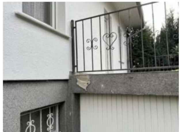
6 Putzabplatzungen über der Garage / Terrasse
