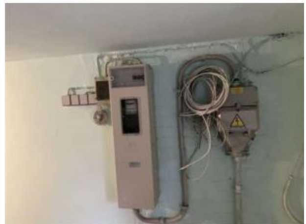
12 Elektrohauptanschluss mit Zähler (KG)
