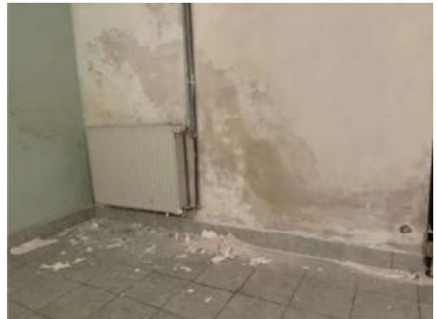
10 Putzabplatzungen und Ausblühungen im KG
