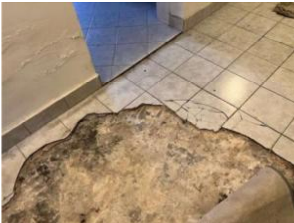
9 zerstörter Fliesenboden im KG (Flur)
