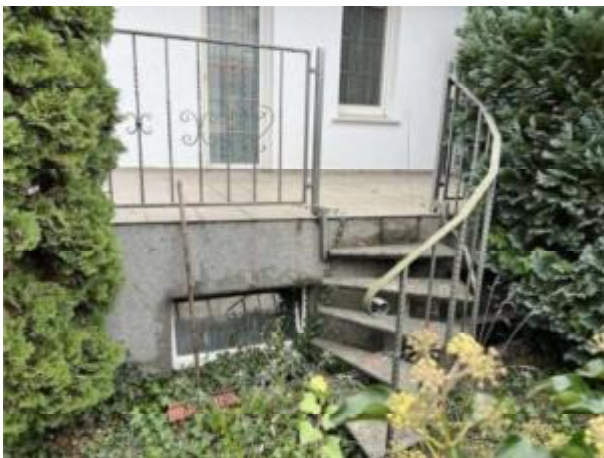
5 Terrasse (EG) mit Beschädigungen
