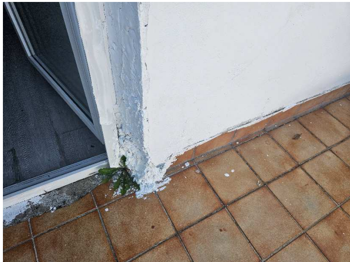
Putzabplatzungen an der Außenfassade im Terrassenbereich -exemplarisch-
