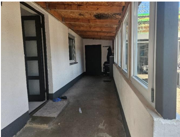
Zugang zum Bewertungsobjekt über Vorbau (mutmaßlich nicht genehmigt)
