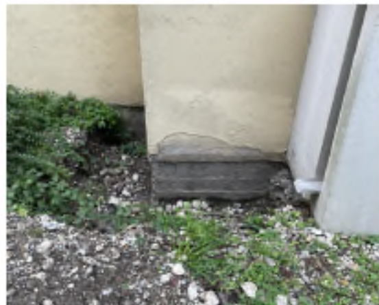
Beispiel von baulichen Auffälligkeiten, hier Sockelbereich Fassade SO, Haus A, Maßnahme aufgrund aufgetretener Feuchtigkeitsspuren im Wohnungsinnenraum
