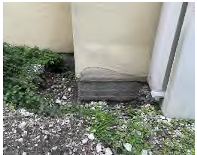
Beispiel von baulichen Auffälligkeiten, hier Sockelbereich Fassade SO, Haus A, Maßnahme aufgrund aufgetretener Feuchtigkeitsspuren im Wohnungsinnenraum
