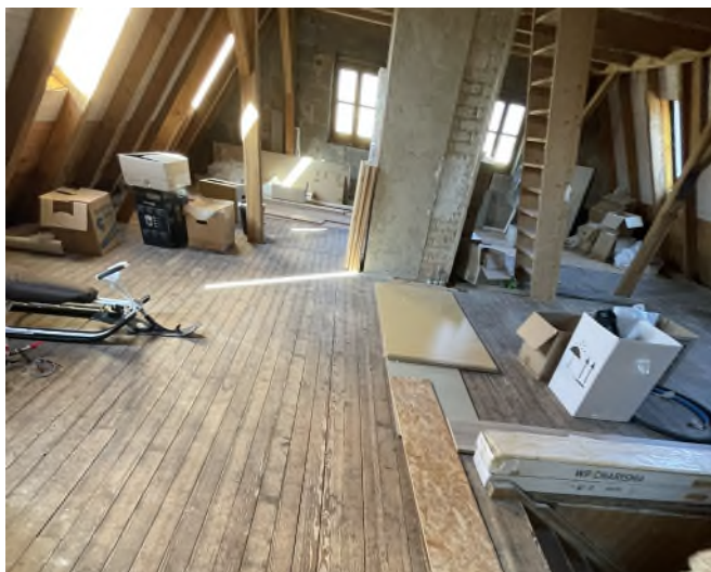
Lageraum im DG, Bewertungsobjekt zu D) lt. ATP Nr. 4 ...
