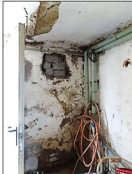
Nebengebäude B – starke Putzschäden
