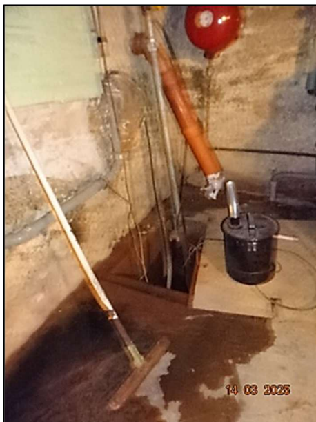
Wohnhaus A – Wasser im Keller
