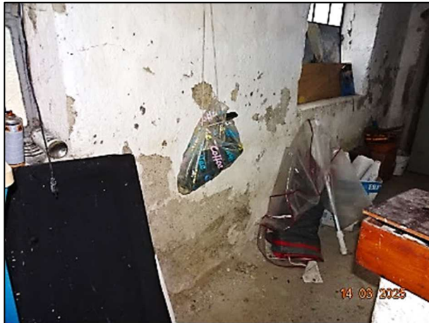
Nebengebäude B – starke Putzschäden
