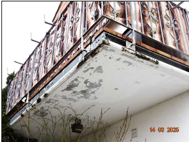
Wohnhaus A – Schäden Balkon
