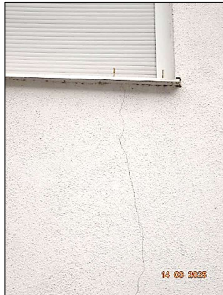
Wohnhaus A – Riss Außenputz
