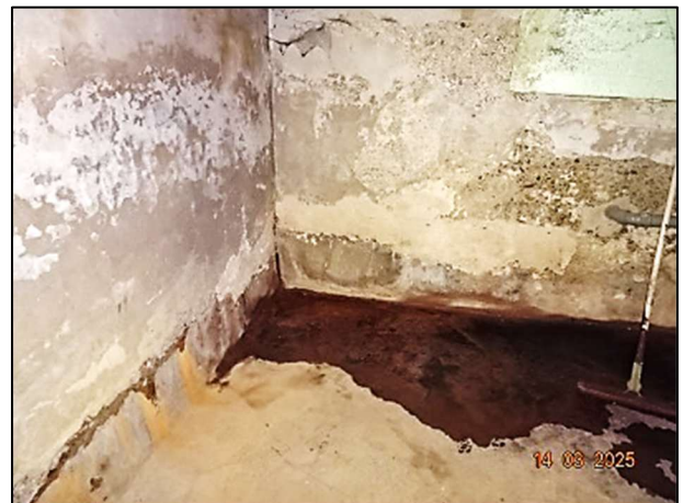
Wohnhaus A - Feuchtigkeitsschäden
