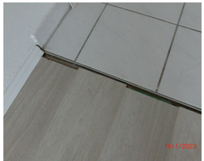
Beispiel nicht fachgerechter Bodenanschluss- / Übergangsbereiche
