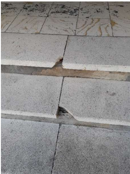
beschädigte Treppe Hauseingang
