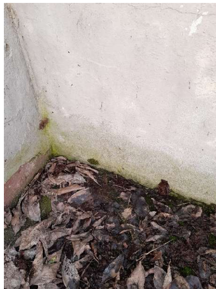
Wasserflecken an der Stützmauer Kellerabgang
