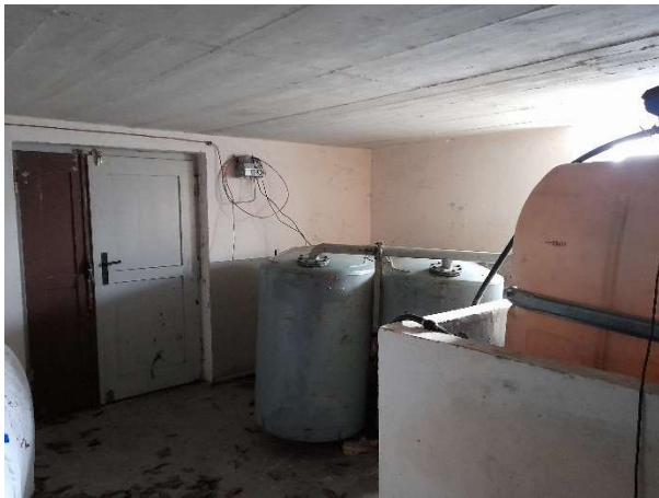
KG – Lageraum mit Öl-Tanks
