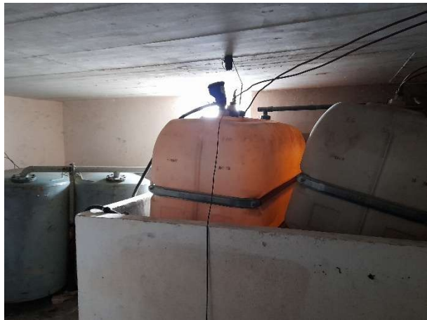
KG – Lageraum mit Öl-Tanks
