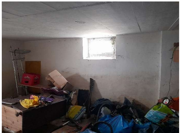
KG – Kellerraum - Beschädigtes Inventar
