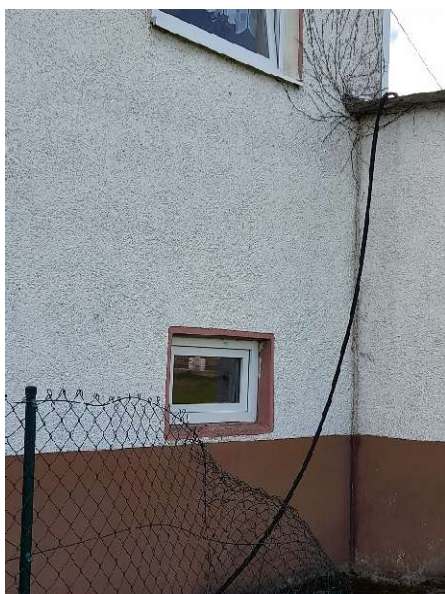
Nach Außen verlegte Leitung zum Obergeschoss
