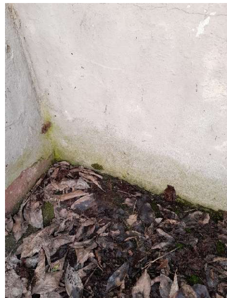
Wasserflecken an der Stützmauer Kellerabgang
