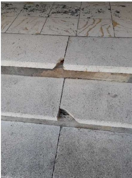
beschädigte Treppe Hauseingang
