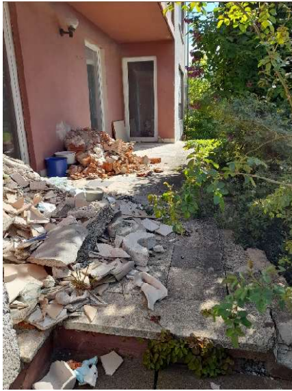
Terrasse mit Bauschutt
