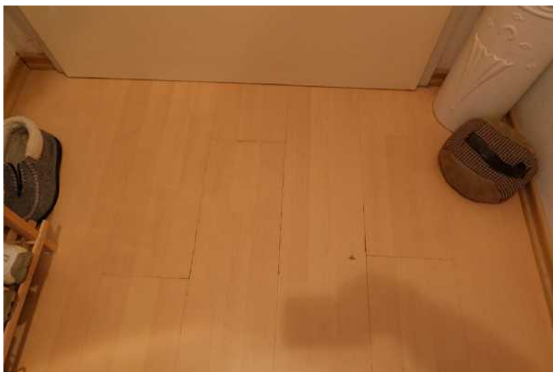
Laminat Flur, Zustand
