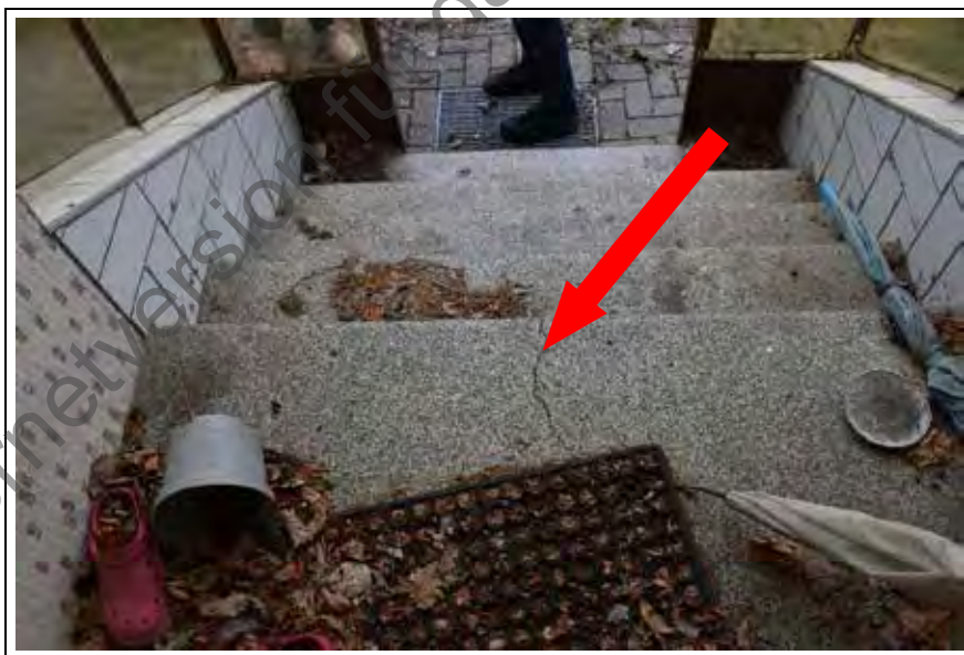
Foto 6: Hauseingang, Stufen mit Rissen
