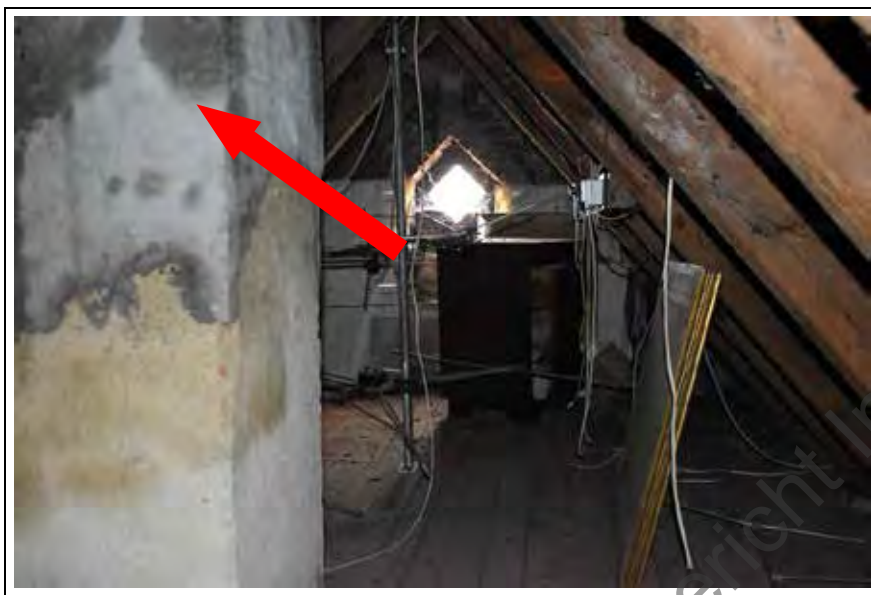
Foto 31: Spitz (Wohnhaus), Kamin mit Feuchtigkeitsschaden
