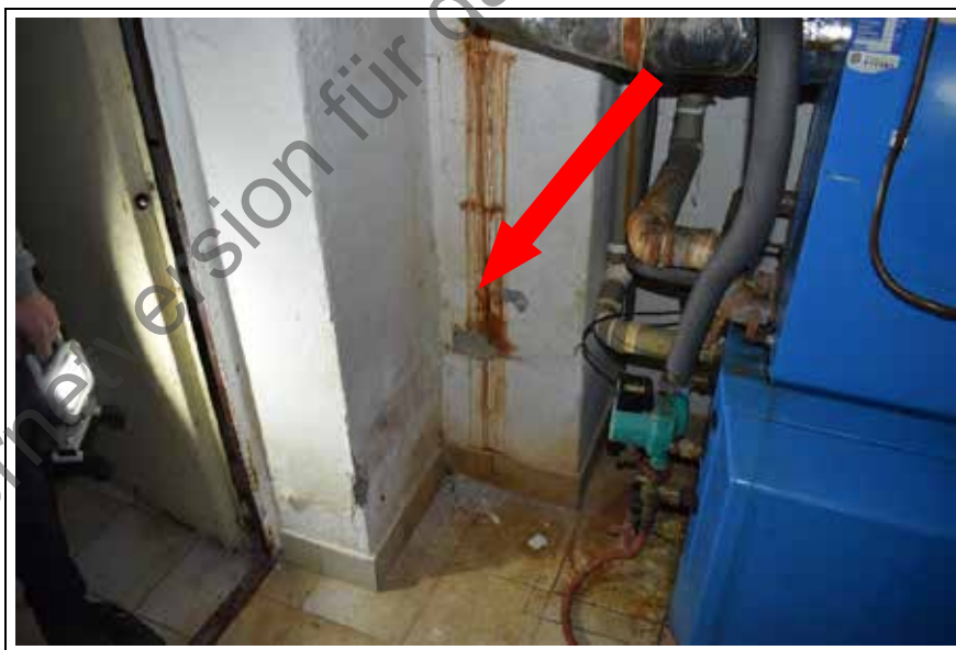
Foto 14: KG, Heizungsraum mit Feuchtigkeitsschäden am Kamin
