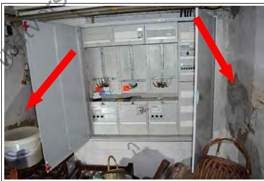
Foto 8: KG, Flur mit Elektroverteilung, Putz- und Anstrichschäden durch Feuchtigkeit
