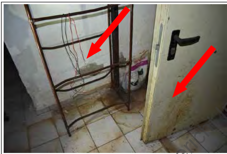
Foto 11: KG, Öltankraum mit Feuchtigkeitsschäden und verrostetem Stahltürblatt
