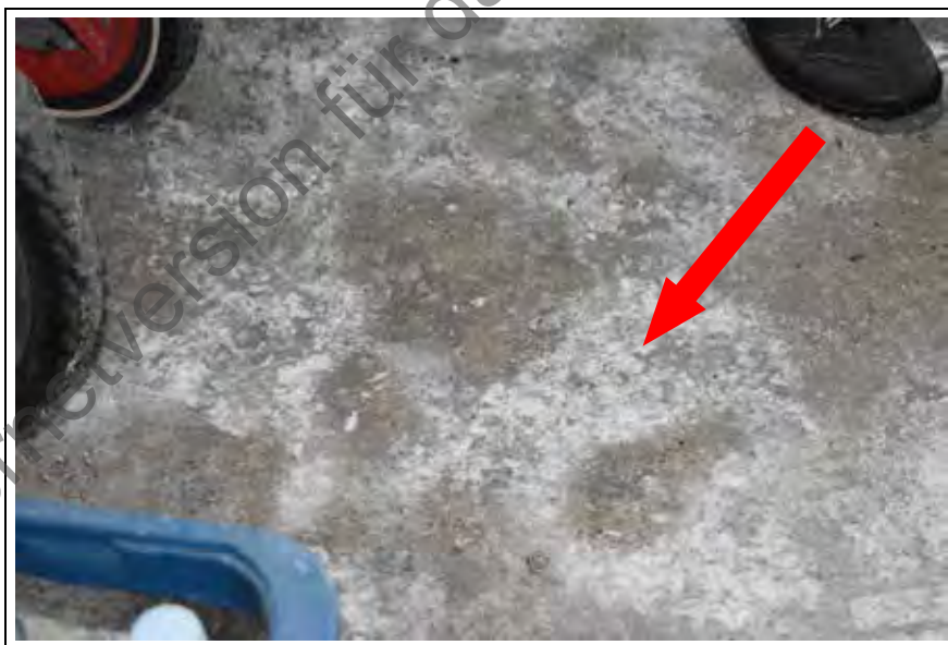
Foto 16: KG, Garage (Anbau), Boden mit Ausblühungen
