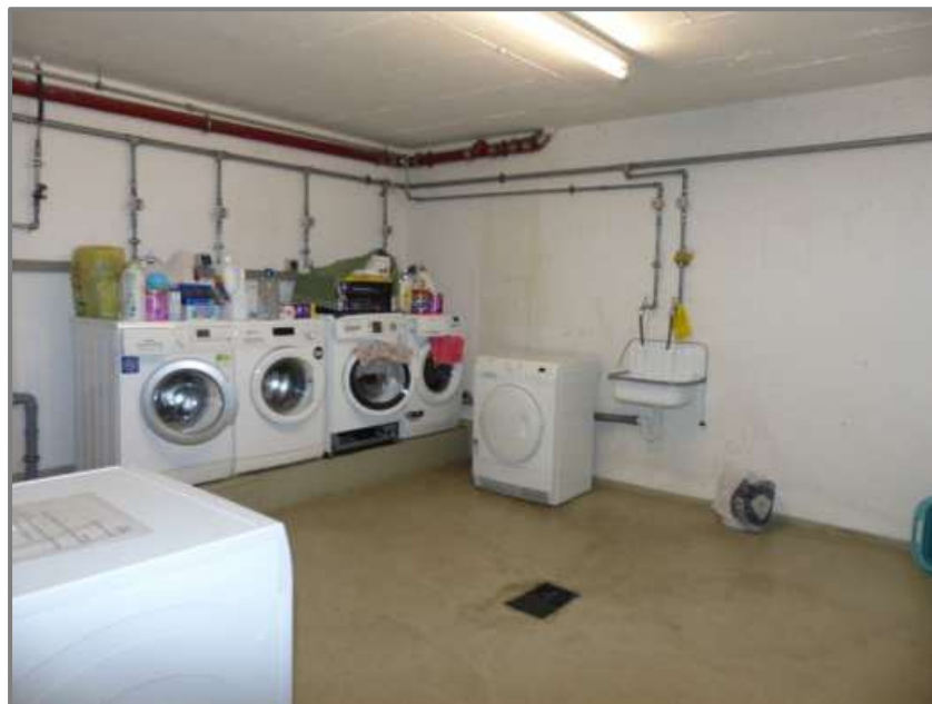
Kellergeschoss (Haus Nr. 5a) – Waschen / Trocknen
