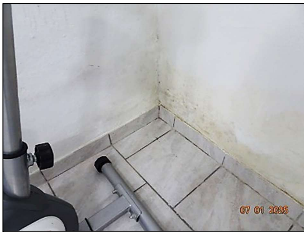
Feuchtigkeitsflecken im Keller
