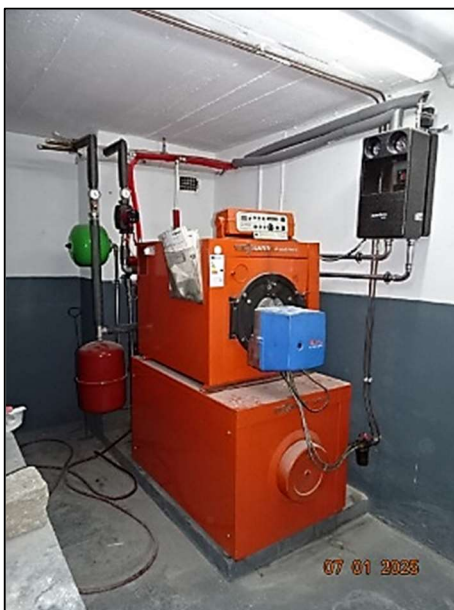
alter Heizkessel Keller
