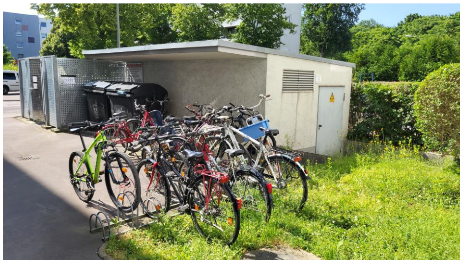
Trafostation auf Grundstück Gutenbergstr. 42, 44, 46, 60 und 62
