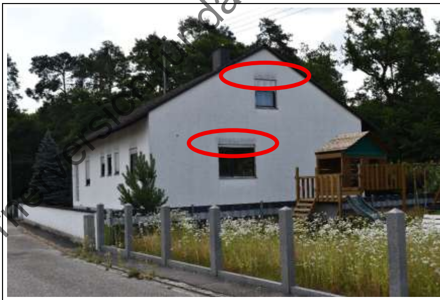
Foto 2: Straßenansicht von West mit Verfärbungen an der Fassade
