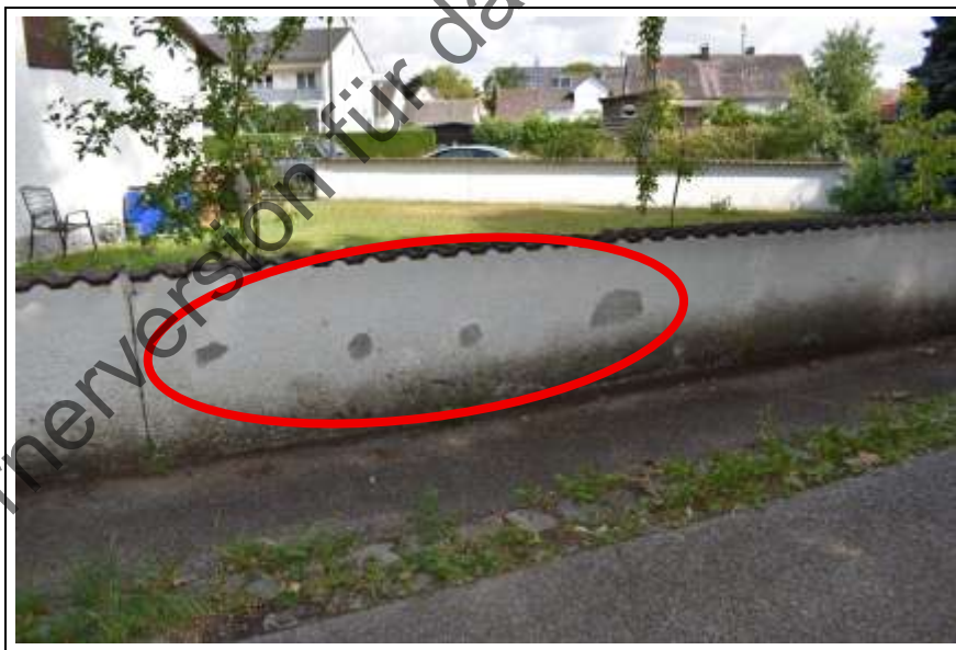
Foto 8: Straßenansicht von Süd (Straße Am Wald), beschädigte Gartenmauer
