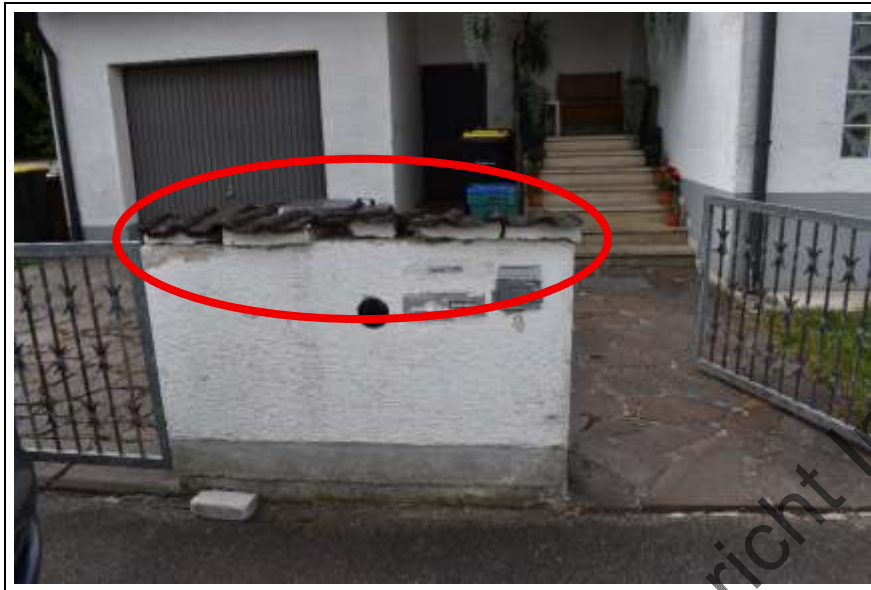
Foto 9: Straßenansicht beschädigte Gartenmauer, Eingangsbereich
