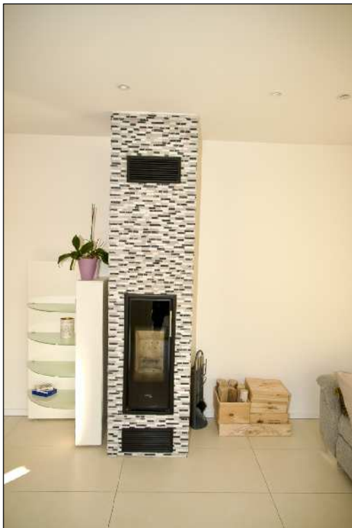
Foto 8 Erdgeschoss - stückholzbefeuert Einzelofen
