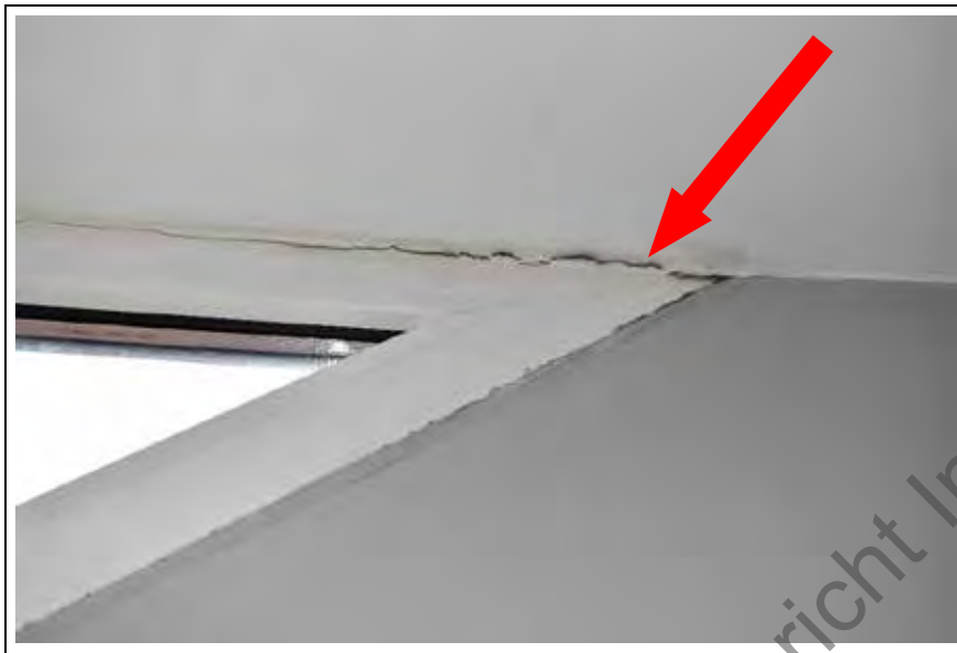
Foto 29: DG, Zimmer, Bereich Fenster mit sich öffnenden Fugen
