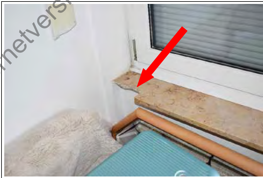
Foto 22: OG, Kinderzimmer 1, Fenster mit gebrochener Fensterbank
