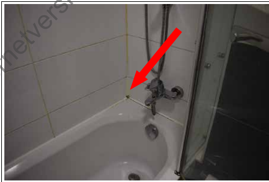
Foto 20: OG, Bad mit Einbaubadewanne (Schimmelpilzbildung an der Verfügung)
