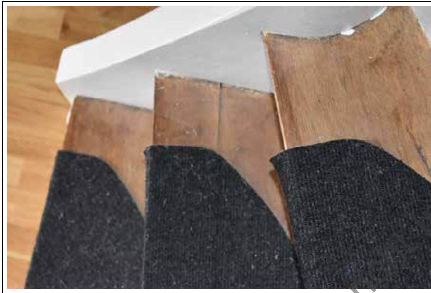
Foto 33: Treppe OG-DG mit gebrochener Trittstufe
