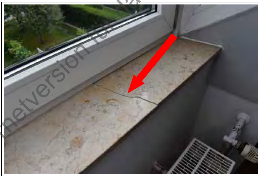
Foto 28: DG, Zimmer, Fenster mit gebrochener Fensterbank
