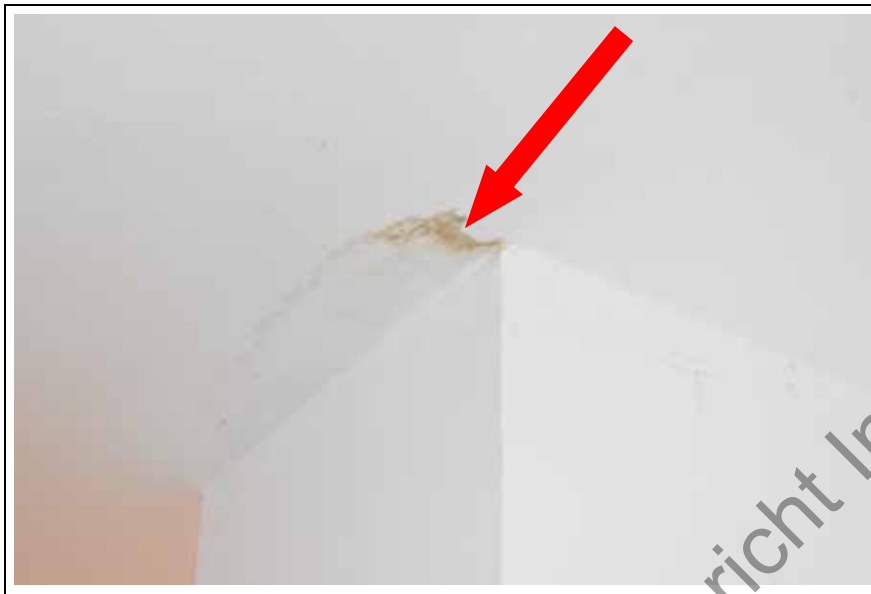
Foto 31: DG, Kammer mit Feuchtigkeitsschaden im Bereich des Kamins
