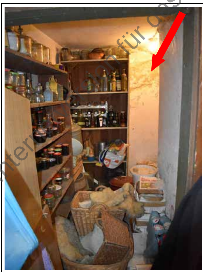
Foto 18: KG, Keller 6 mit Feuchtigkeitsschäden
