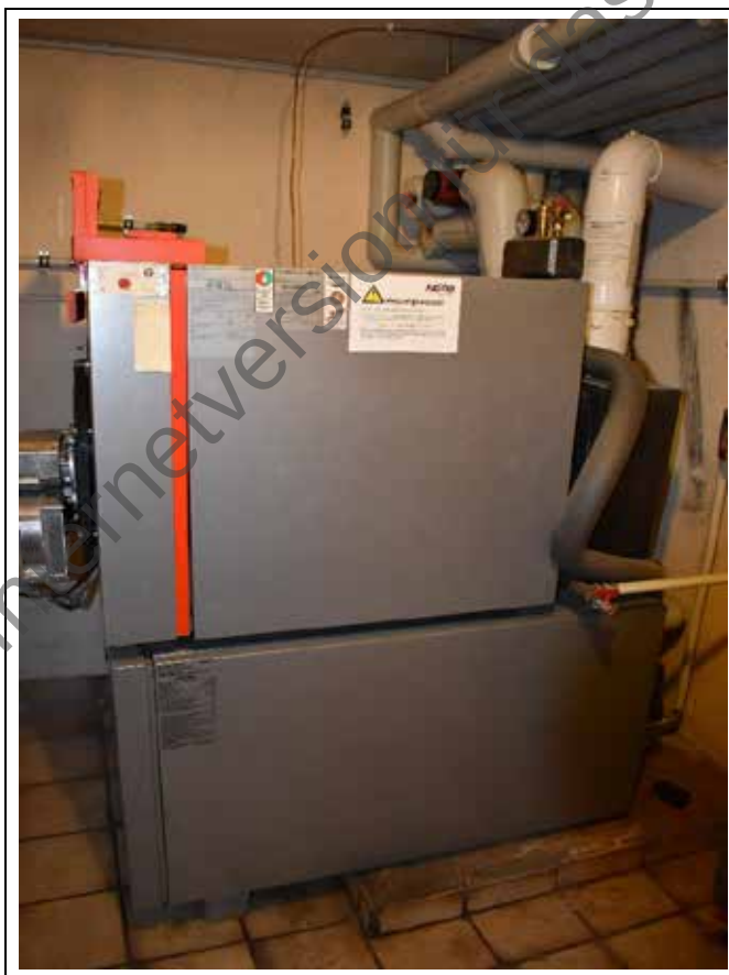
Foto 16: KG, Heizungsraum / Heizung
