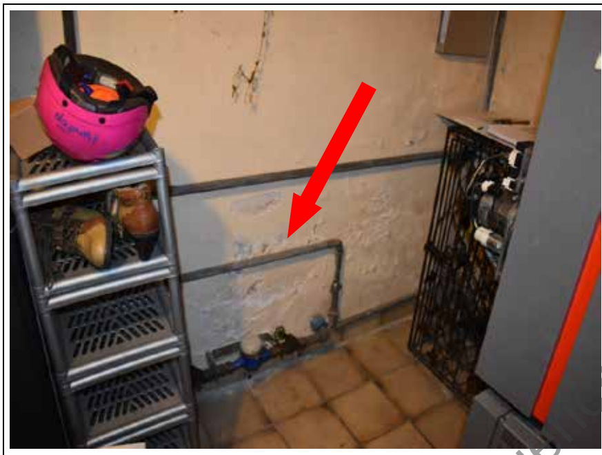
Foto 15: KG, Heizungsraum mit Feuchtigkeitsschäden
