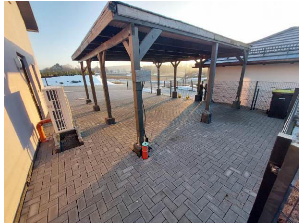
Carport mit nicht fertiggestellter Entwässerung
