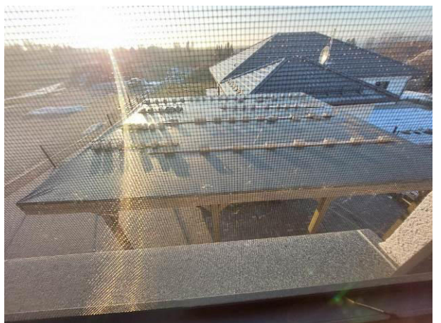
Carport mit nicht fertiggestellter Dacheindeckung
