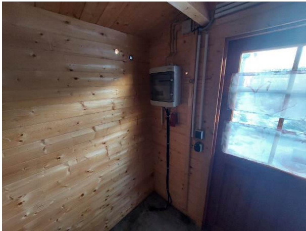
Gartenhaus elektr. Verteilung mit Starkstromanschluss
