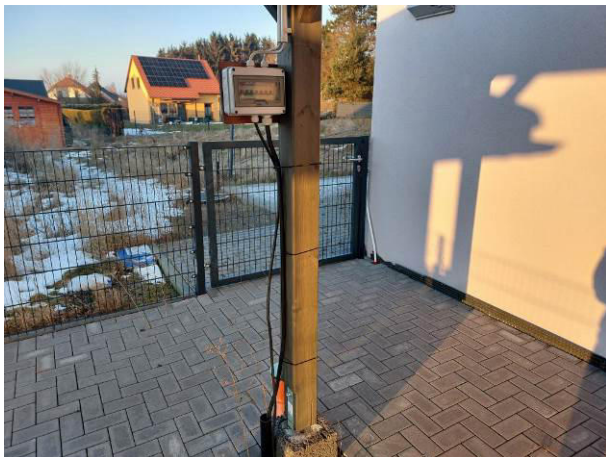
Carport mit offener elektr. Verteilung
