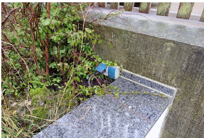
Elektroinstallation im Garten
