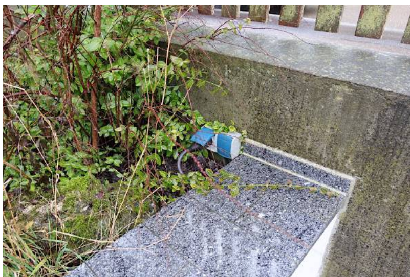
Elektroinstallation im Garten
