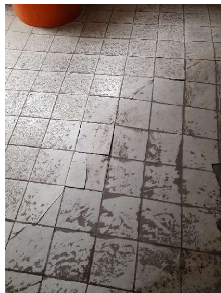
KG - Wasserschaden in Waschküche
