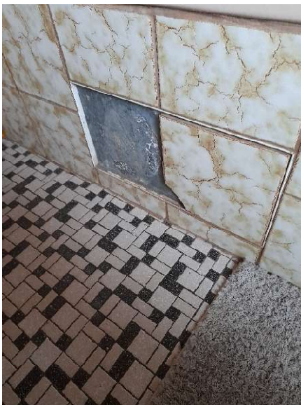
EG – Bad – beschädigte Fliesen
