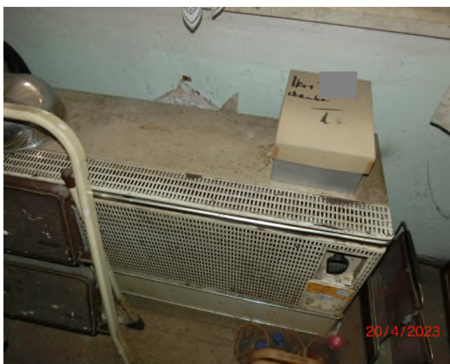
Beispiel der vorhandenen Heizgeräte in der Bewertungswohnung, Nachtspeicherofen
